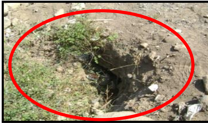
Figura 33. Fotografía a la salida de la alcantarilla, emboquillado en Km 65+909. Fuente: Propia.
