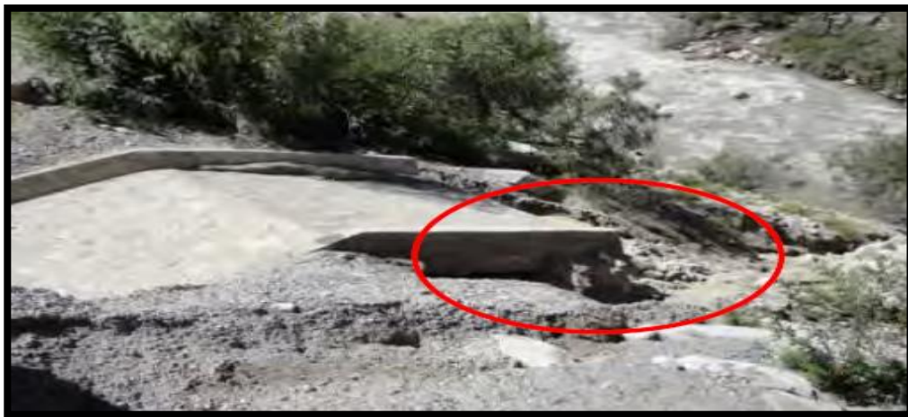
Figura 12. Socavación de solado de mampostería en alcantarilla Churín – Oyón, por Núñez, J. 2014
