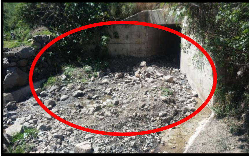
Figura 37. Fotografía a la salida de la alcantarilla, emboquillado en Km 74+140. Fuente: Propia.
