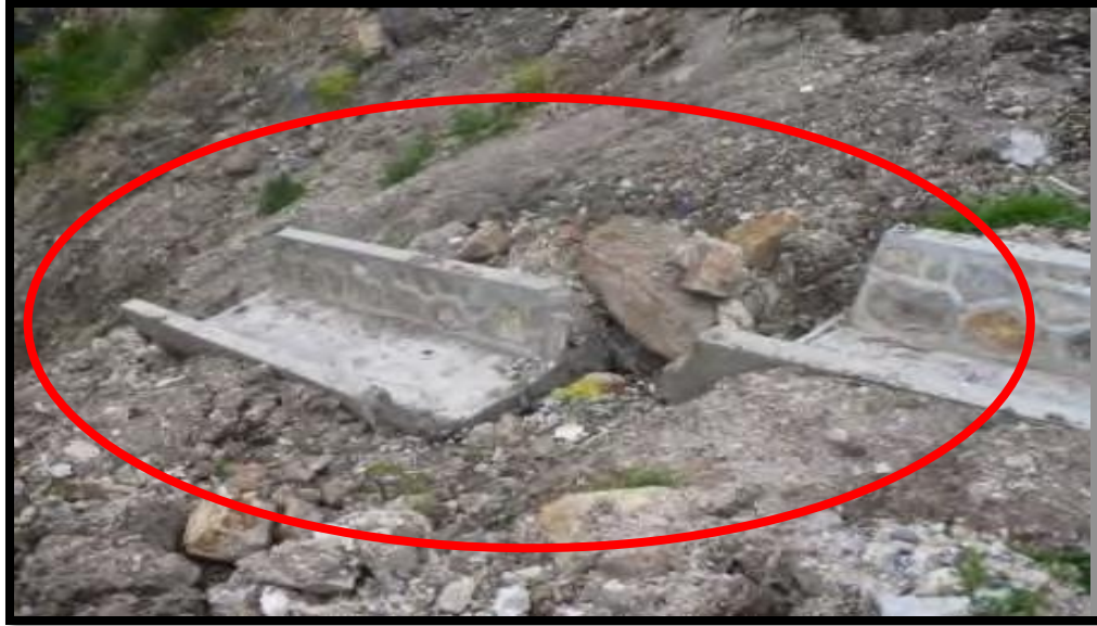
Figura 11. Vista de colapso de la mampostería a la salida de la alcantarilla carretera tramo Churín – Oyón por Núñez, 2014.
