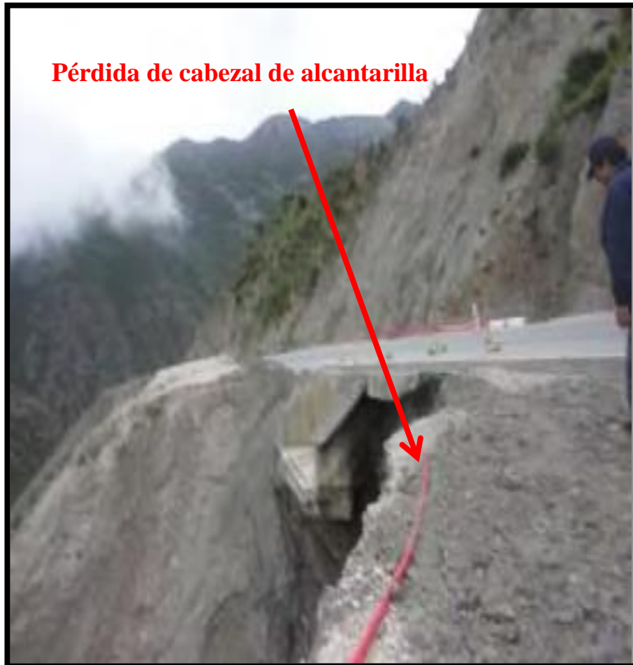
Figura 14. Falta prolongación de emboquillado de alcantarilla Churín – Oyón., por Núñez, 2014.
