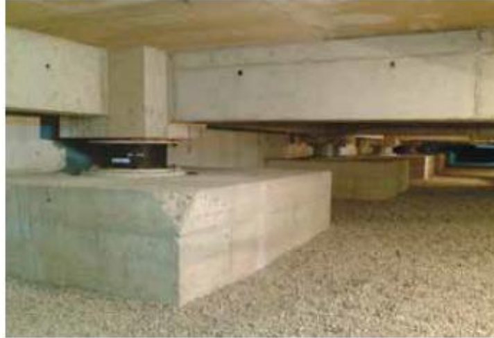
Figura 6. Aplicación aislador en edificio san agustín (Chile)
