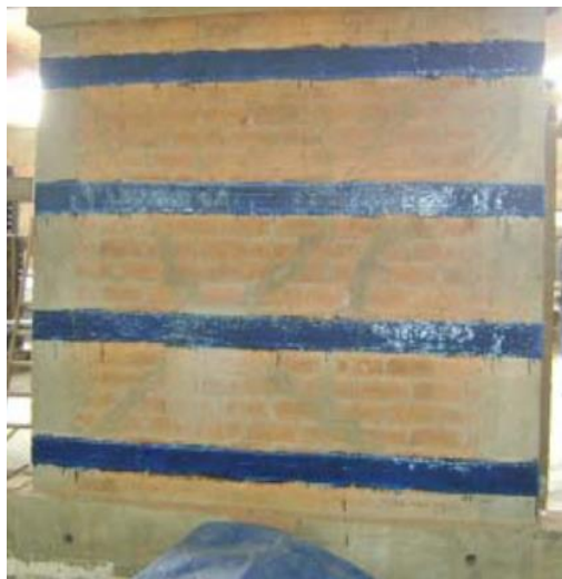
Figura 35. Vista final de la reparación del muro portante reforzado con fibra de carbono
