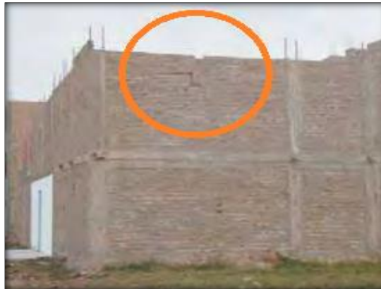
Figura 2. Falla en la parte superior media del muro por separación de más de 5.5m Fuente: Kuroiwa y Salas, 2009
