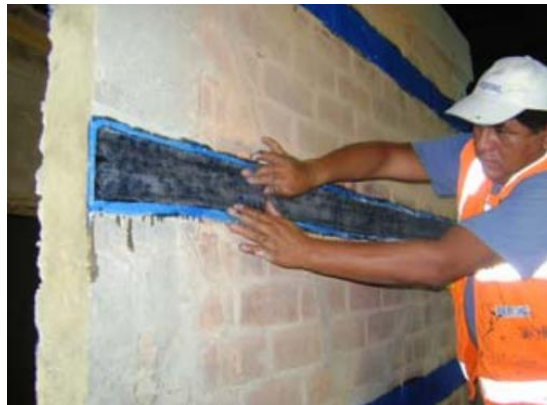
Figura 32. Aplicación de la resina Mbrace Saturant haciendo uso de rodillo Fuente: Bartolomé, 2010
