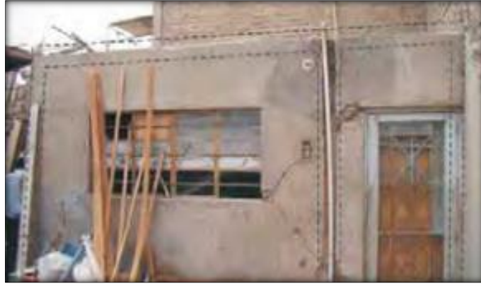
Figura 4. Falla de tracción diagonal o corte en la fachada de una vivienda que carece de columnas de refuerzo y viga de amarre.
