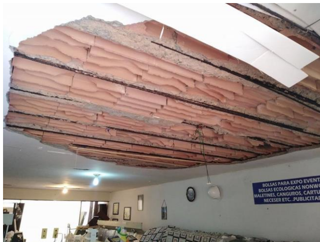
Figura 9. Losa aligerada con acero de vigueta corroído
