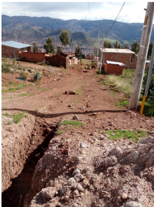
Imagen N° 26: Vista de trabajos de instalación de servicios de la APV Alto Qosqo, se observa el sistema de desagüe se encuentra en plena etapa de ejecución.
