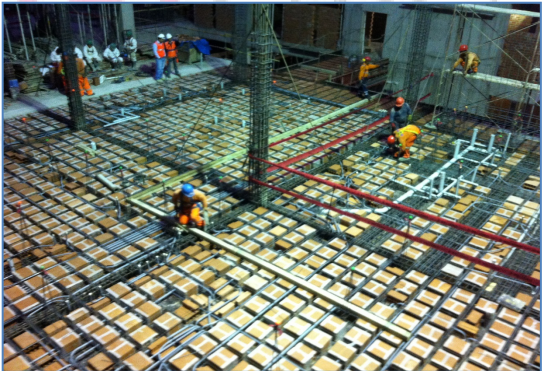
Foto N° 05.- Espera de mixer de concreto, colado de concreto en losa aligerada del primer nivel Sector C3.
