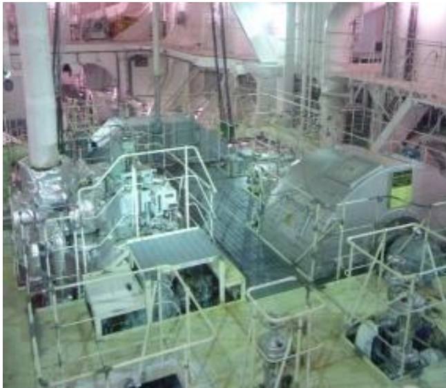
Ilustración 43: Configuración real de la planta del lado de estribor UST. Fuente: Mitsubishi Heavy Industries.
