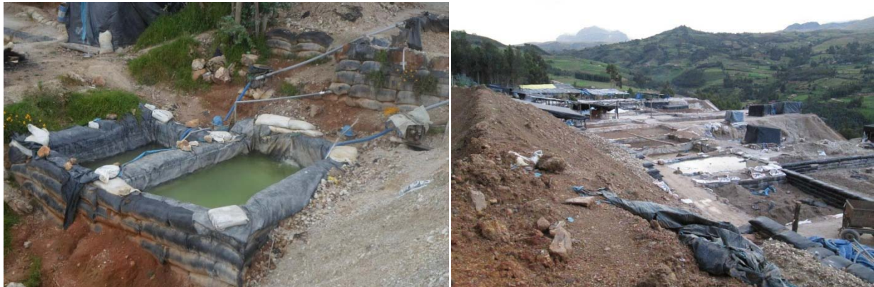
Fig. 16 y 17: Vista Lateral del proceso de beneficio de minerales auríferos oxidados por el método "VAT LEACHING"
