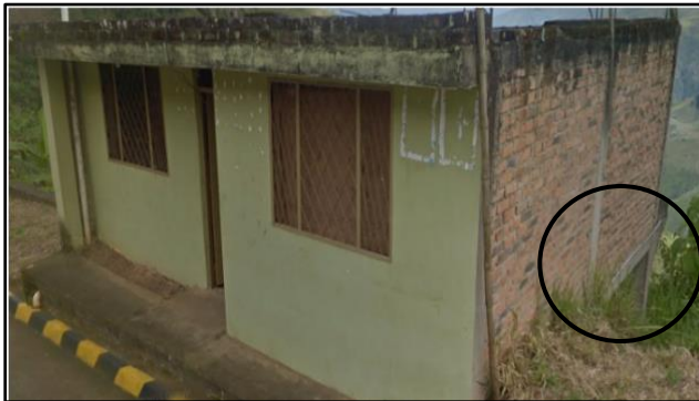
Figura 49. Vivienda en zona de deslizamiento, sector La Carrera. Fuente: Esta investigación.
