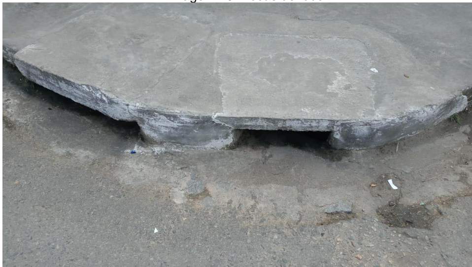
Imagem 26: Bocas de lobo.
