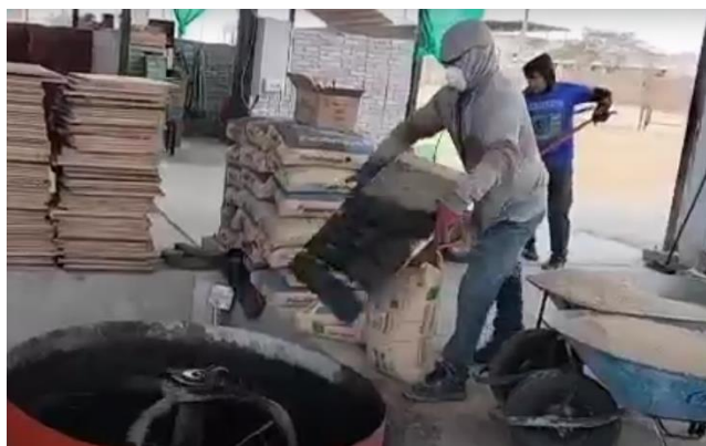
Ilustración 7: Reproceso de bloques dañados
