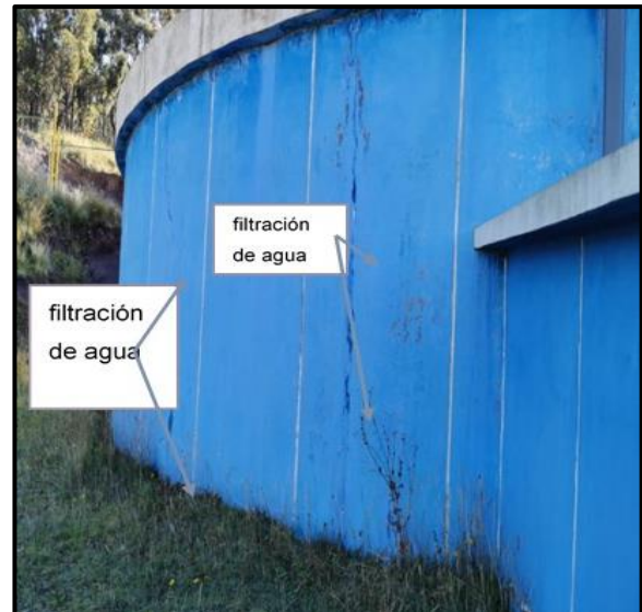
Figura N° 7. Reservorio existente. Fuente: Elaboración propia.
