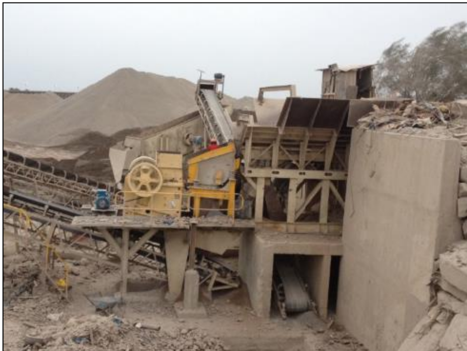
Figura 17. Maquina chancadora y tolva alimentadora
