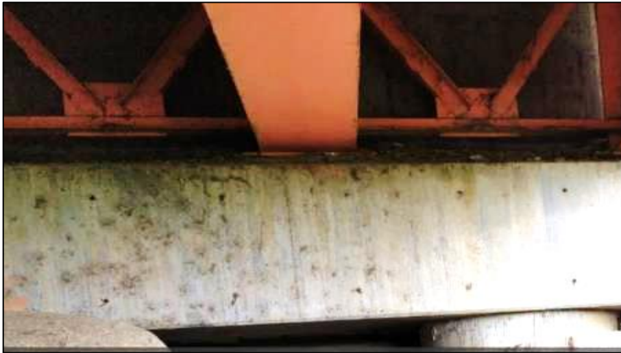
Figura 24. Suciedad y polvo en los arriostres de acero.
