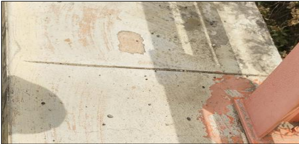
Figura 58. Desgaste del concreto armado por la intemperie en la vereda.
