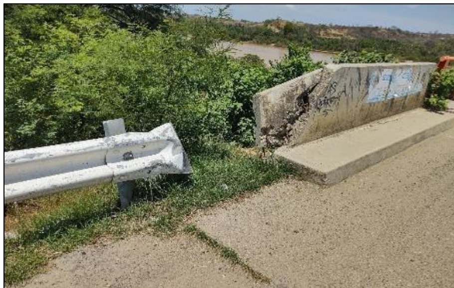
FIGURA 33. Fractura en ala del estribo derecho
