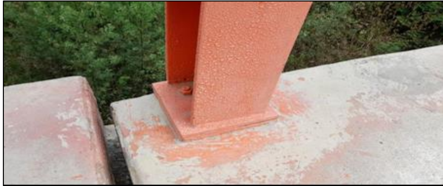
Figura 80. Desgaste de pintura en las barandas, en uno de los tramos reticulados.
