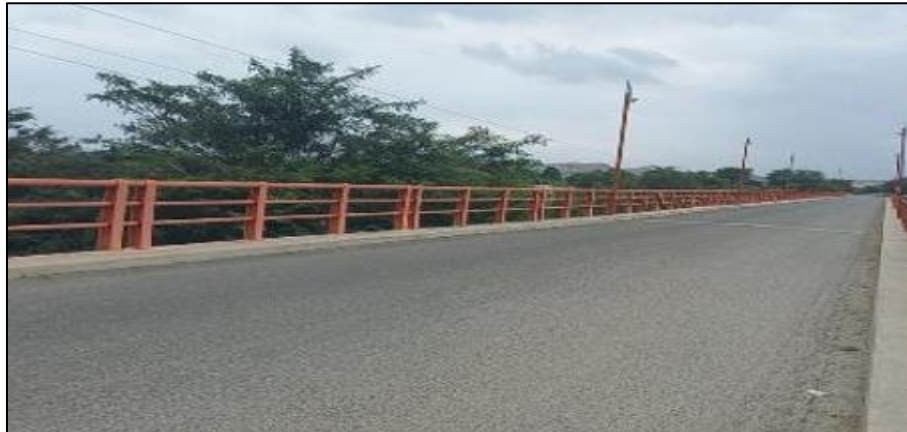
Figura 47. Capa de asfalto del puente Francos
