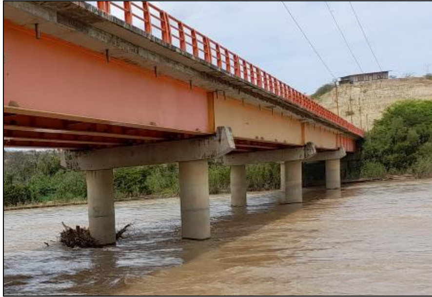
Figura 42. Manchas de humedad en los pilares.
