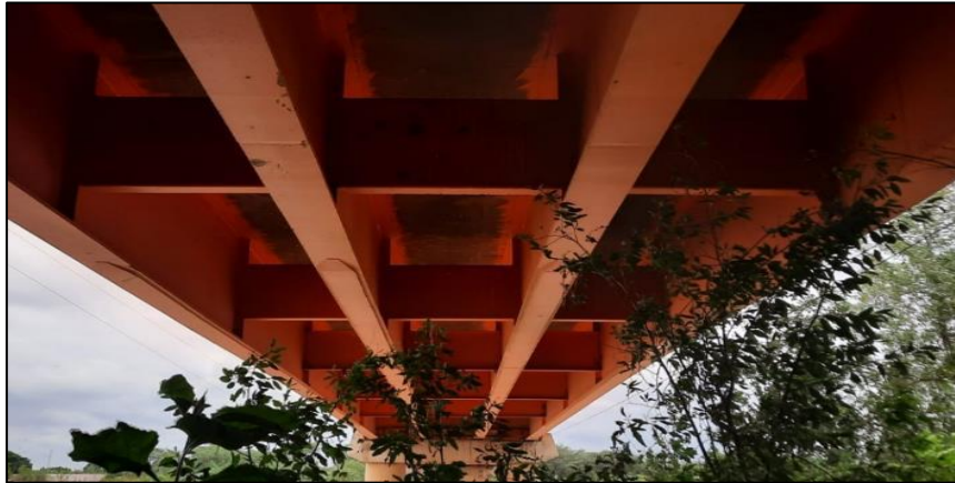
Figura 11. Vista de las vigas de acero estructural del tablero del puente Francos.
