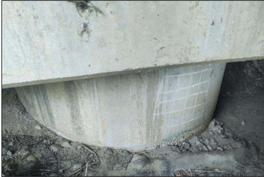
Figura 30. Fisuras de menos de 1.5 mm por retracción.
