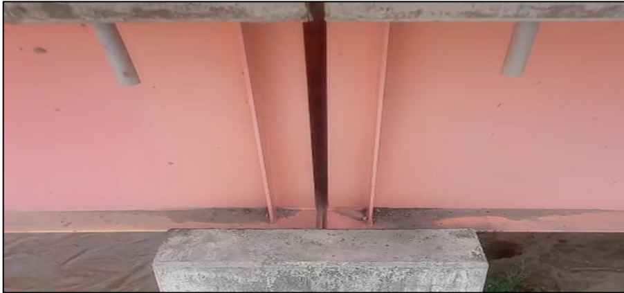
Figura 13. Giro debido a la flexión de vigas en el pilar 1, aguas abajo. Se aprecia diferencia de espesor de junta entre la parte inferior y superior de la viga. Aparentemente no se ha considerado contraflecha para contrarrestarlo.
