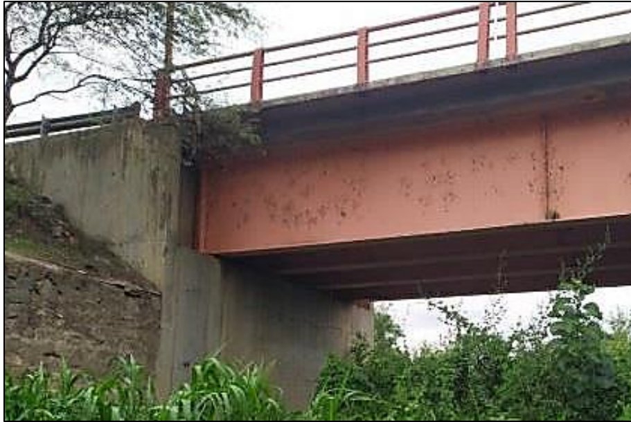
Figura 19. Viga de acero estructural con presencia de hongos y materia orgánica
