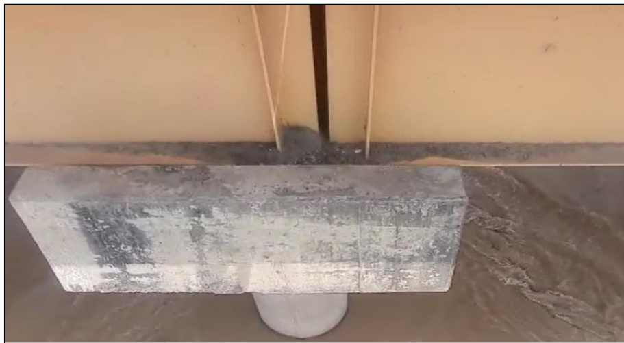
Figura 46. Detalle de extremos de vigas en el pilar 3, aguas abajo.
