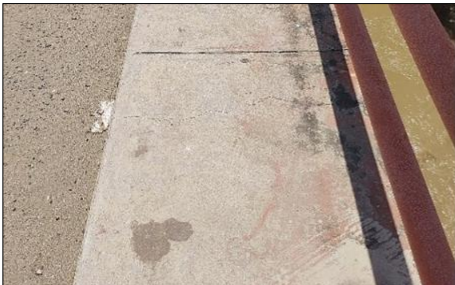
Figura 56. Fisuras en la vereda aguas abajo.
