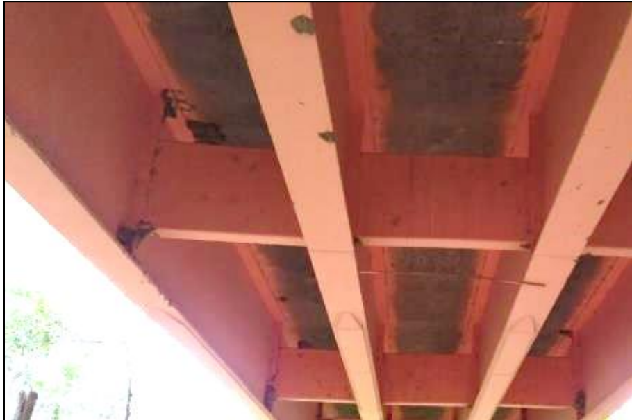
Figura 8. Losa de concreto armado (refuerzo transversal) del puente Francos, con presencia de nidos de aves.
