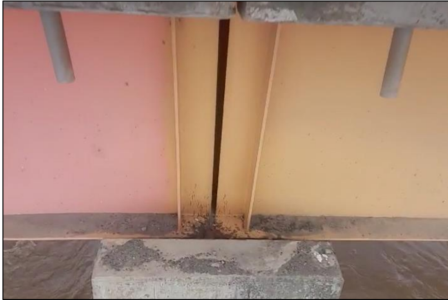
Figura 17. Giro debido a la flexión en las vigas en el pilar 5, aguas abajo. Se aprecia diferencia de espesor de junta entre la parte inferior y superior de la viga. Aparentemente no se ha considerado contraflecha para contrarrestarlo.
