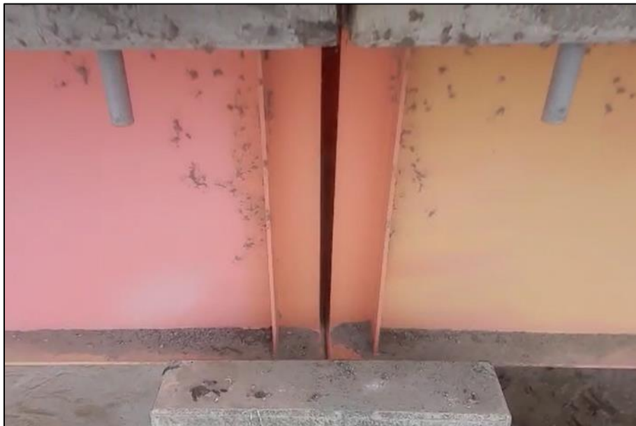
Figura 16. Giro debido a la flexión en las vigas en el pilar 5, aguas arriba. Se aprecia diferencia de espesor de junta entre la parte inferior y superior de la viga. Apparently no se ha considerado contraflecha para contrarrestarlo.
