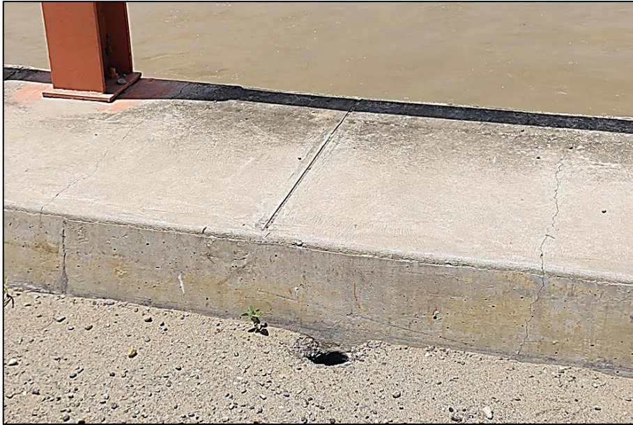
Figura 57. Fisuras en la vereda aguas arriba.
