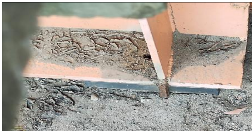
Figura 67. Apoyo fijo del estribo derecho obstruido por impurezas.
