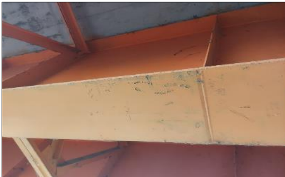
Figura 18. Desprendimiento de pintura, raspones en vigas de acero estructural
