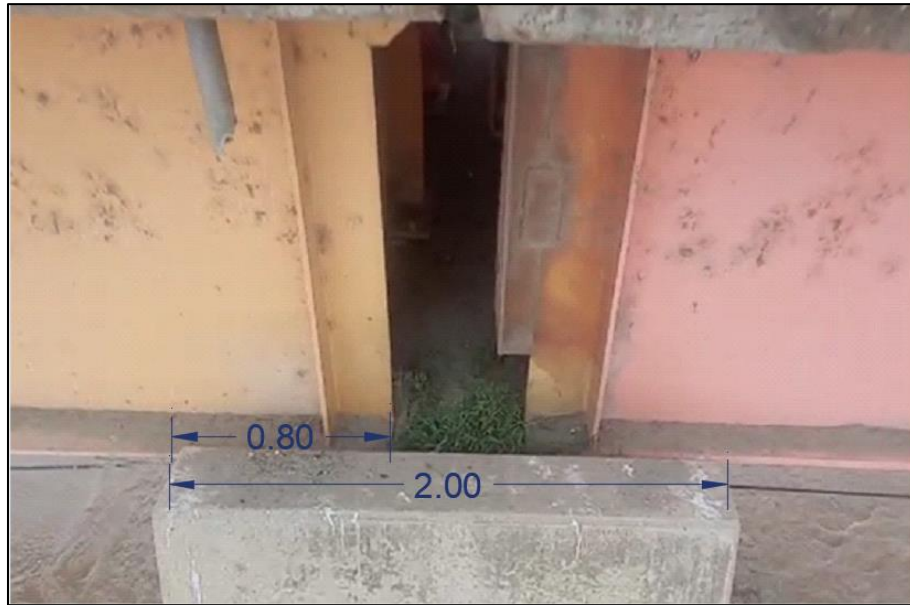
Figura 43. Detalle de extremos de vigas en el pilar 2, aguas arriba. Presencia de vegetación en los cabezales de los pilares.
