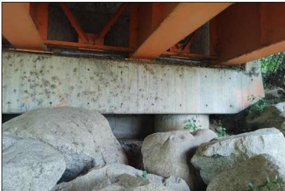
Figura 31. Estribo derecho con suciedad y polvo.
