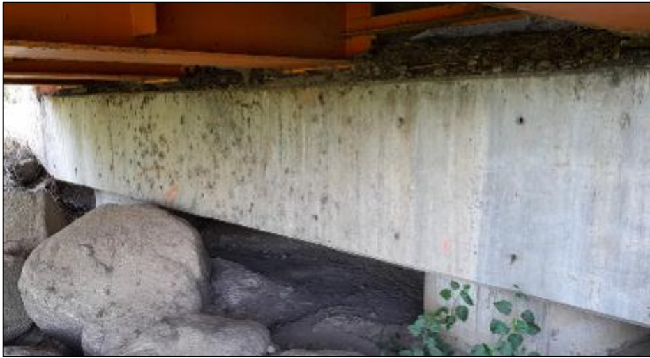
Figura 63. Vista de los apoyos en el estribo derecho del puente Francos obstruidos por impurezas.
