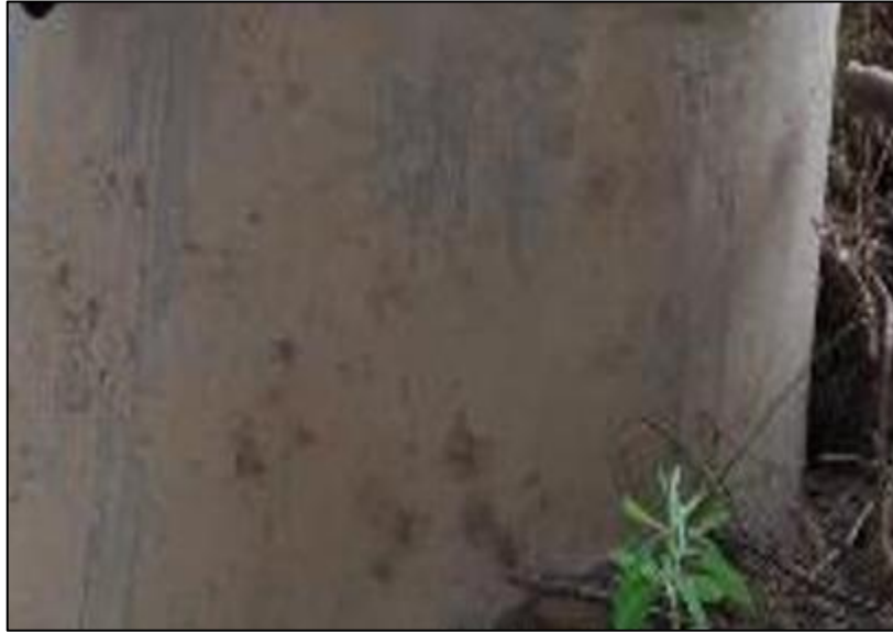
Figura 40. Presencia de hongos y humedad en el pilar 1.
