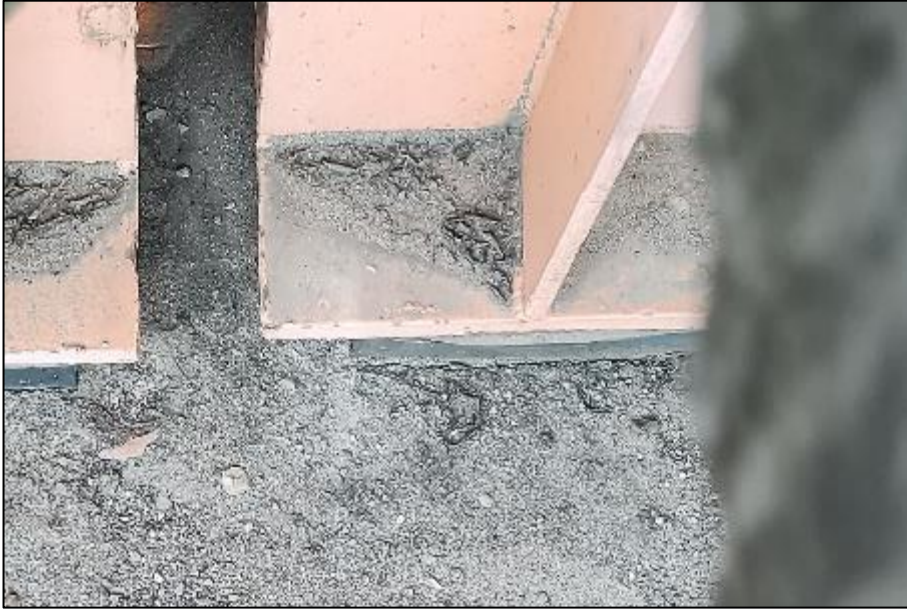
Figura 65. Apoyo fijo del pilar 1 (de la construcción original, antes del FEN 98) del puente Francos aparentemente tiene placas de acero interiores horizontales en el apoyo de neopreno que permiten menores abultamientos. Se puede observar abultamiento lateral en la tercera parte superior.
