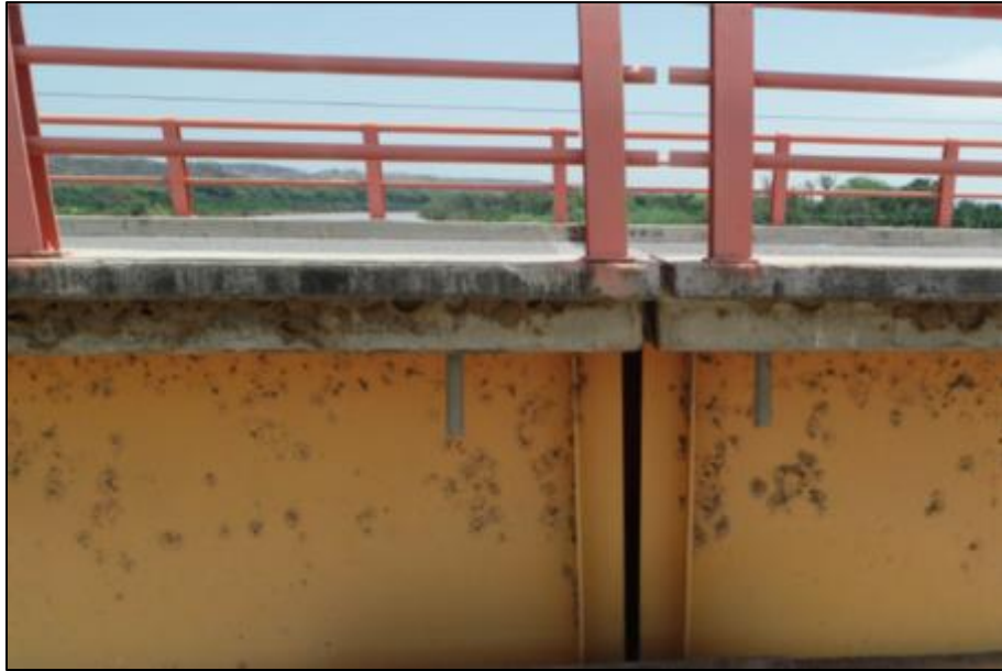
Figura 9. Losa de concreto armado (refuerzo transversal) del puente Francos, con presencia de nidos, suciedad y polvo.
