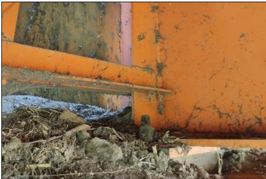
Figura 64. Apoyo fijo del estribo derecho obstruido por impurezas.
