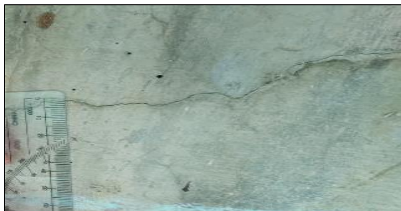
Figura 29. Fisuras de menos de 1.5 mm por retracción.
