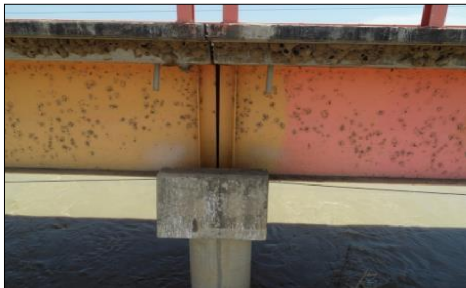
Figura 14. Giro debido a la flexión en las vigas de acero en el apoyo del pilar 4. Se aprecia diferencia de espesor de junta entre la parte inferior y superior de la viga. Aparentemente no se ha considerado contraflecha para contrarrestarlo.
