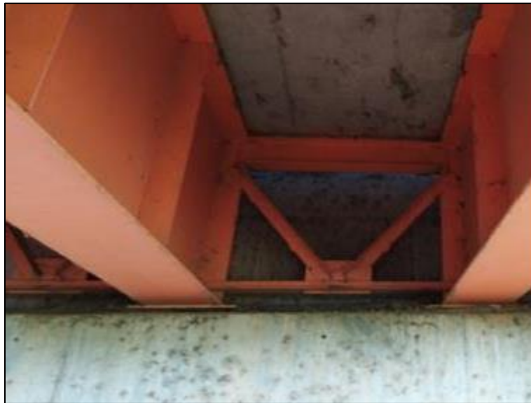
Figura 10. Losa de concreto armado (refuerzo transversal) del puente Francos, con manchas por humedad en la losa.
