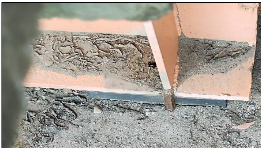
Figura 66. Apoyo fijo del estribo derecho obstruido por impurezas.
