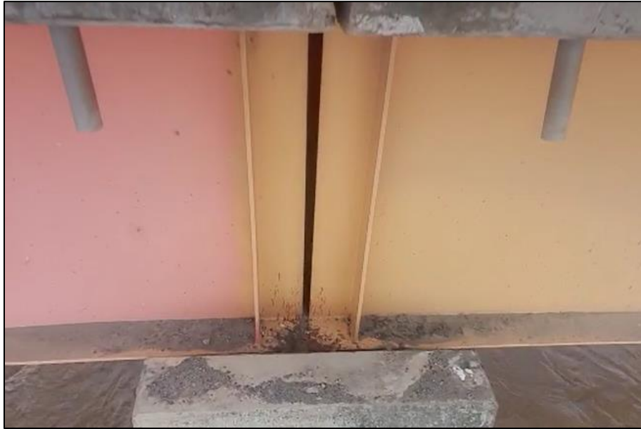
Figura 15. Giro debido a la flexión en las vigas en el pilar 4, aguas arriba. Se aprecia diferencia de espesor de junta entre la parte inferior y superior de la viga. Apparently no se ha considerado contraflecha para contrarrestarlo.
