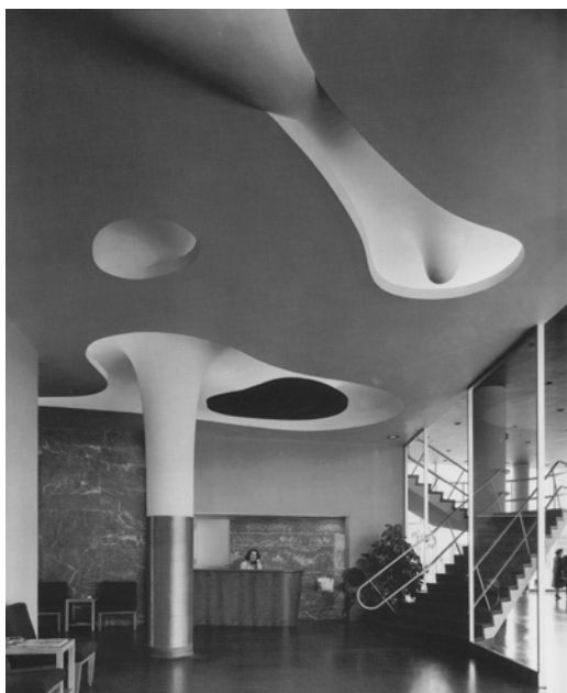
Techo para el edificio de American Stove , Missouri, 1948. Escayola y electricidad.
