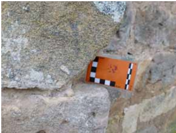
Figura 4: Esquinas fracturadas ( dipping broken corners ) en un contrafuerte del ábside de la iglesia románica de Quintana-Urria (Burgos).
