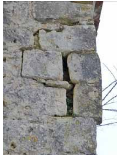
Figura 6: - Desplazamientos de bloques de sillería en uno de los contrafuertes del muro norte de la iglesia románica de Nidágula (Burgos).
