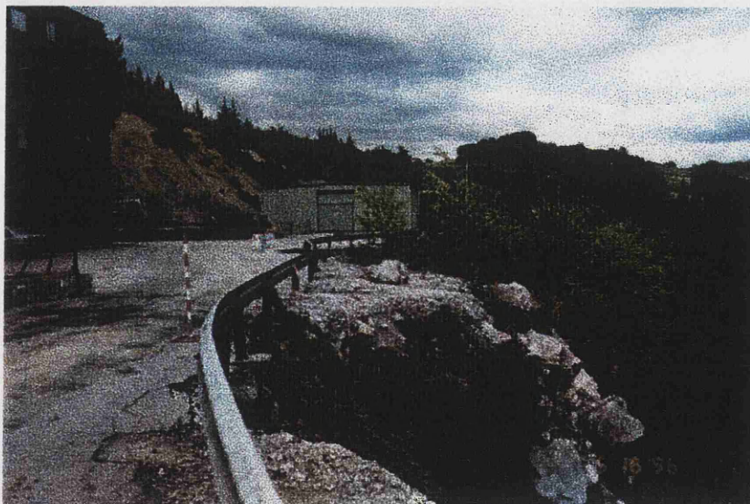
Fotografía 6. Deslizamiento de suelo de la ladera izquierda de la balsa de estériles.
