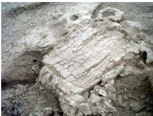
Lámina 7 Lienzo caído del revoco de la pared lateral. Foto Areco.
