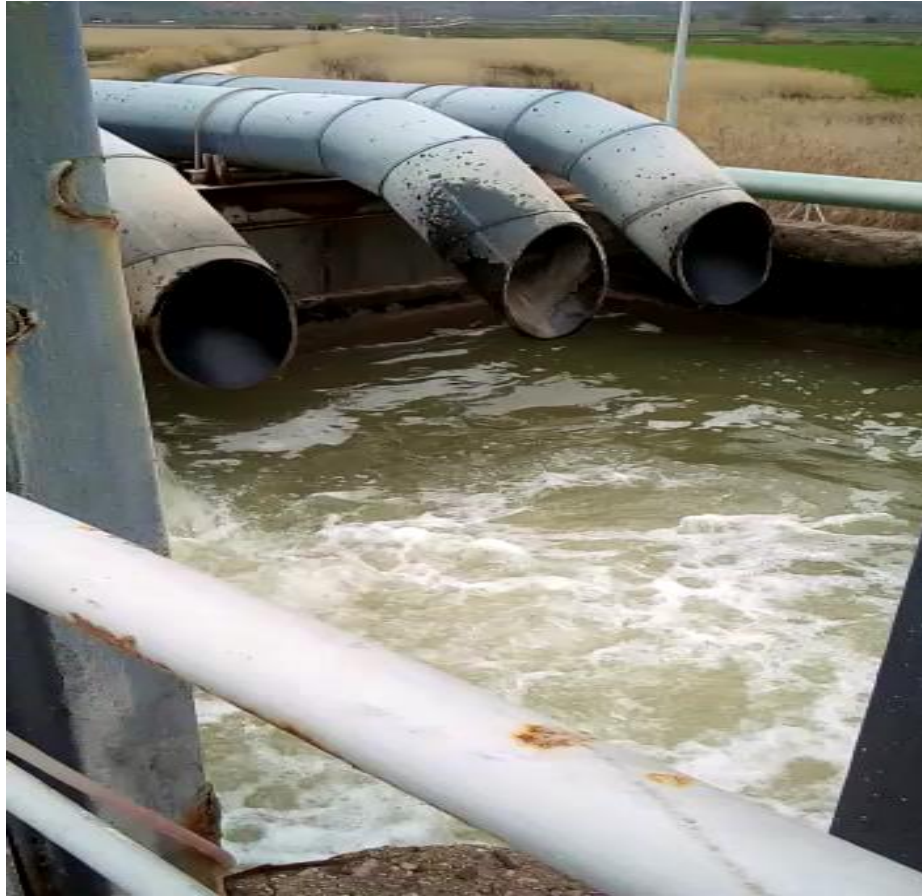
POZO DE GRUESOS
