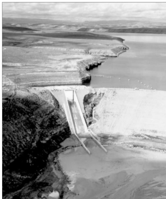
Obr. 10 Porušená hráz Fontenelle (převzato Wiley, 2008).
