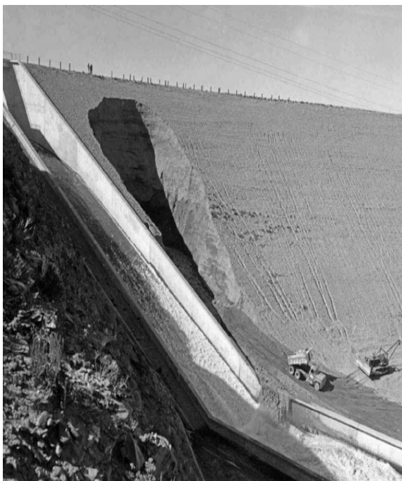
Obr. 9 Porušená hráz Fontenelle (převzato Wiley, 2008)
