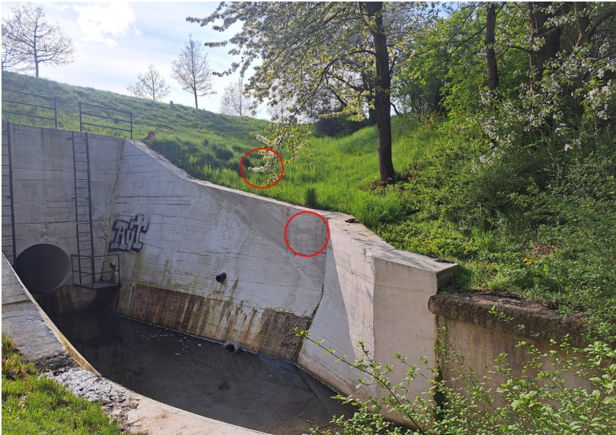
Obr. 18 Znázorněná místa, kterými prosakovala voda tělesem hráze.
