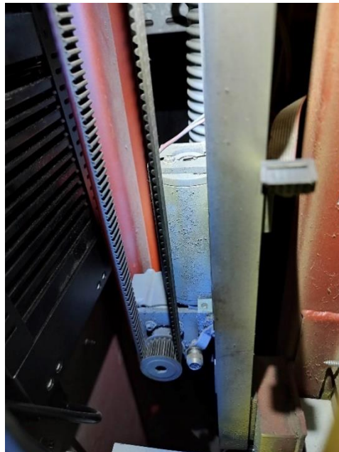
Figura 5 - Motor elétrico (Portas de Salão).
