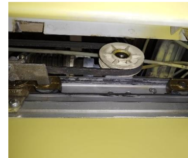
Figura 6 - Correia Trapezoidal e (Portas de Intercomunicação).
