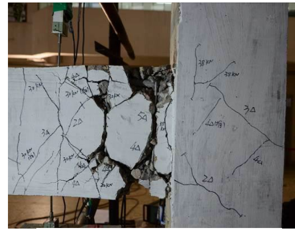
(d) The joint at failure
