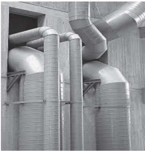
Figuur 5.18 Luchtkanalen in het zicht in het Amsterdam UMC, locatie Meibergdreef
