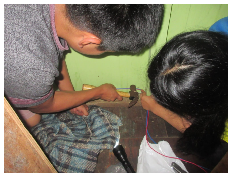
Figura 5. Instalaciones eléctricas Fuente: Autoras
