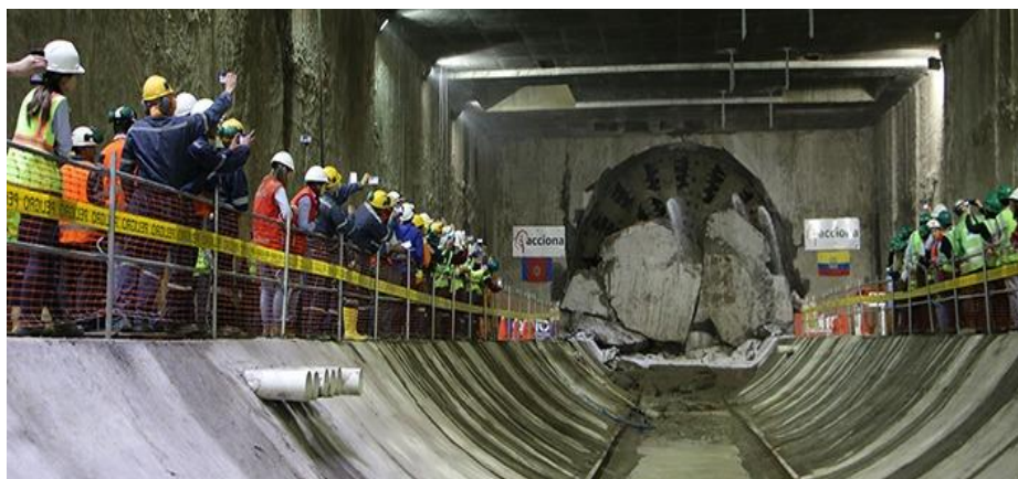
Figura 2 Tuneladora "La Guaragua"
