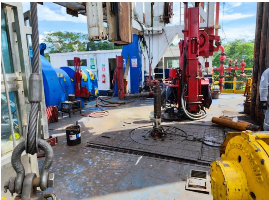
Mesa donde se instala el equipo de corrida de casing y tubing
