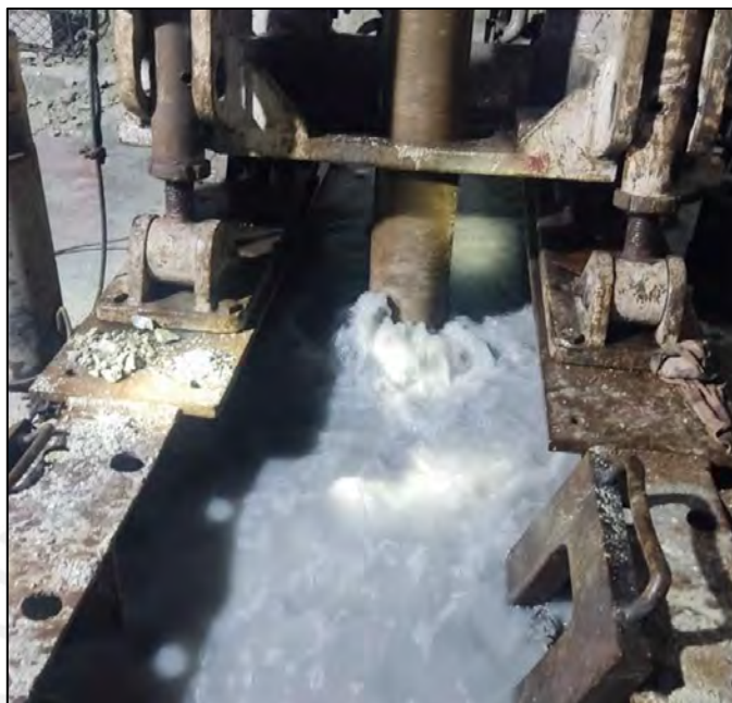
Figura 51. Evacuación de detritus de piloto
