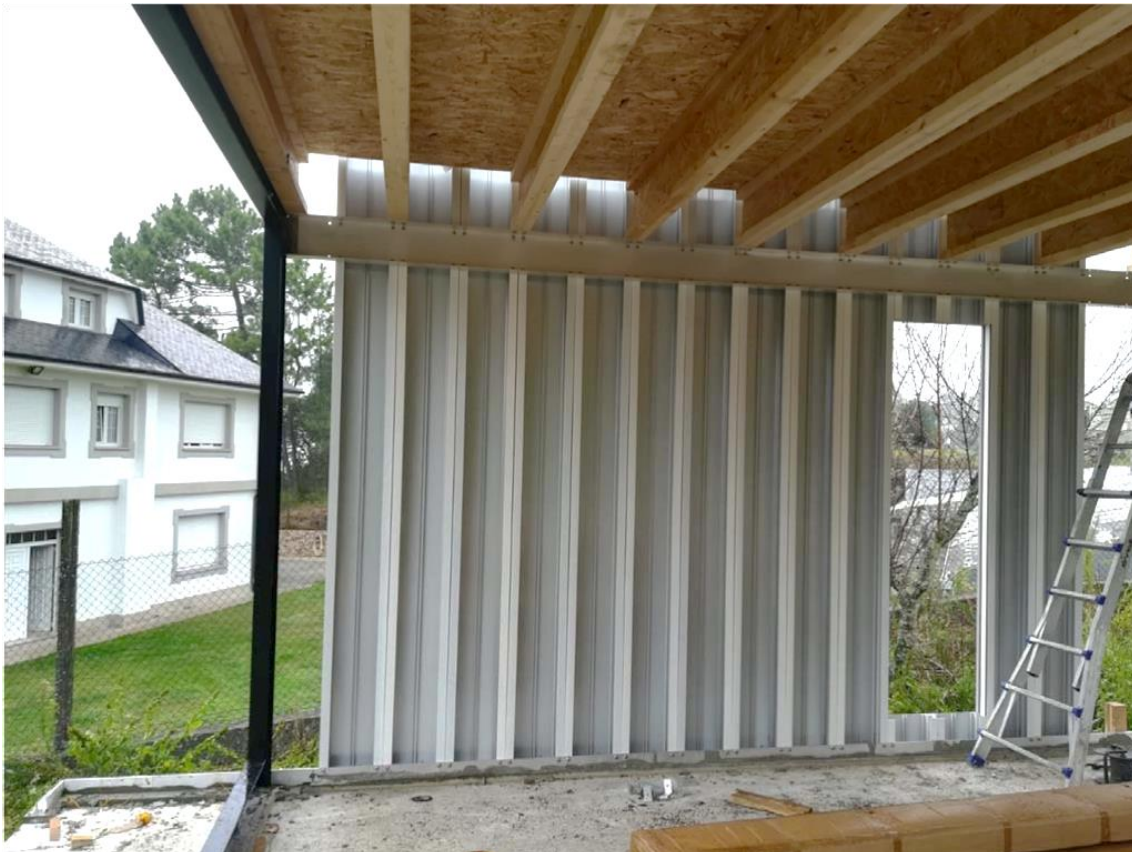
Figura 36. Unión entre paneles de muro y vigas de forjado. Fuente: Patricia Liñares Méndez.
