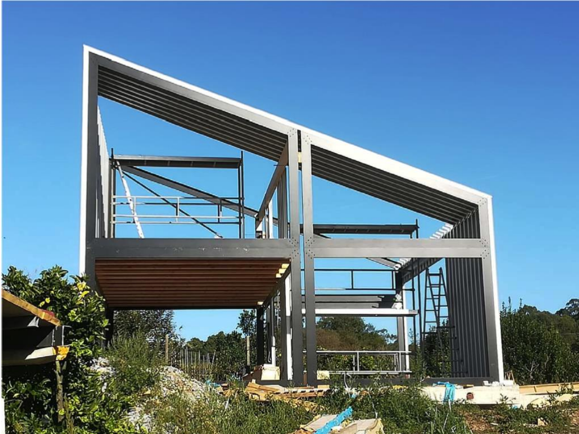
Figura 37. Marcos de fachadas hastiales y su unión a los demás componentes del sistema. Fuente: Patricia Liñares Méndez.
