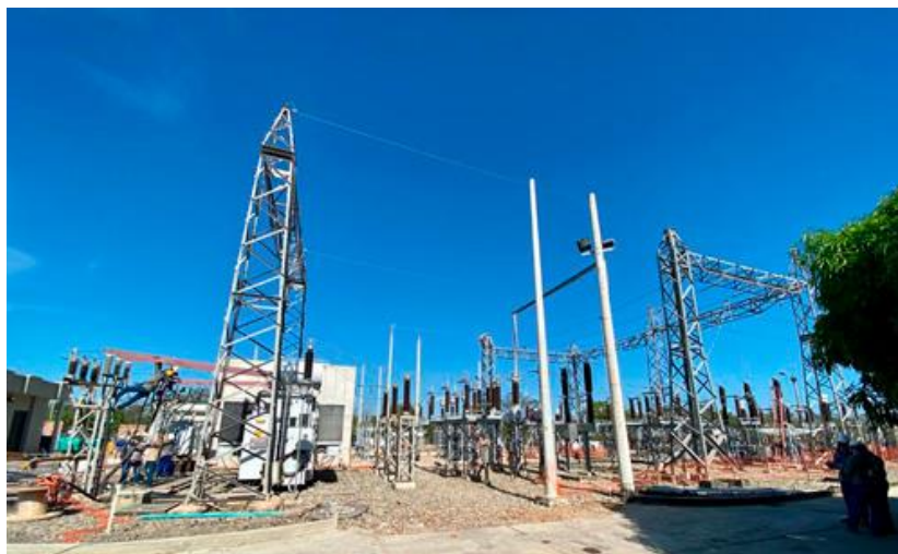
Figura 19 Subestación Gambote Afinia EPM
