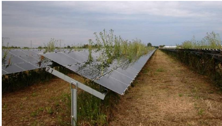
Figura 32. Maleza en Paneles Solares Fotovoltaicos
