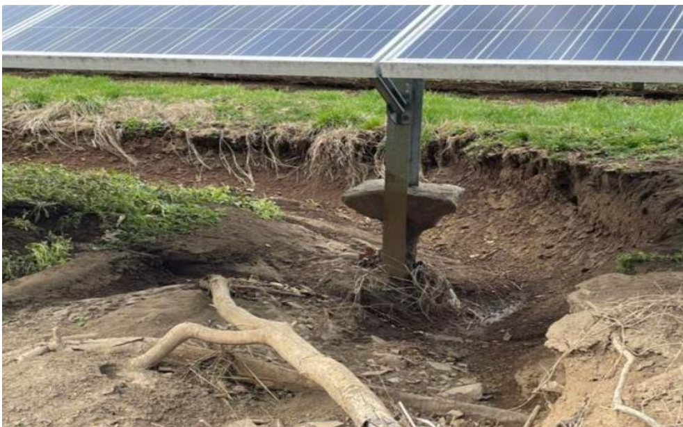
Figura 33. Terreno sin Adecuación
