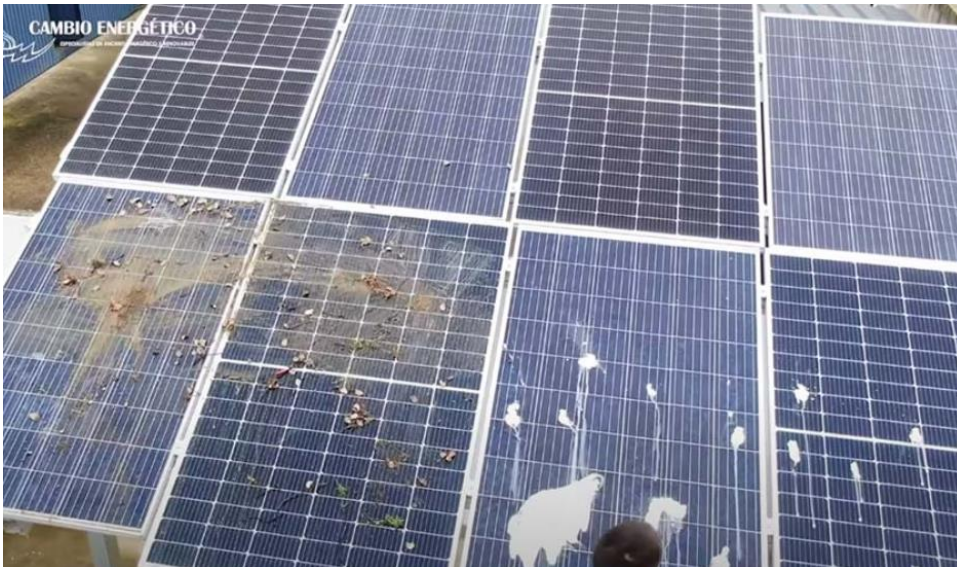
Figura 34. Daños en los Paneles Solares Fotovoltaicos
