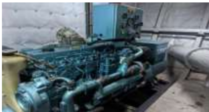
Gambar 1. Mesin Diesel Generator Kapal KN. SAR SADEWA 231
