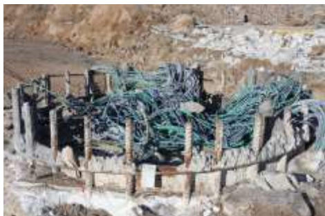
Рис. 2. Встановлення датчиків в об'єкті моніторингу
