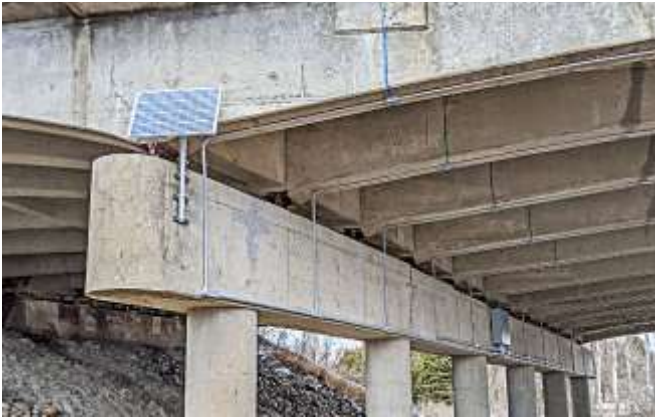
Рис. 7. Система моніторингу опорних конструкцій мосту
