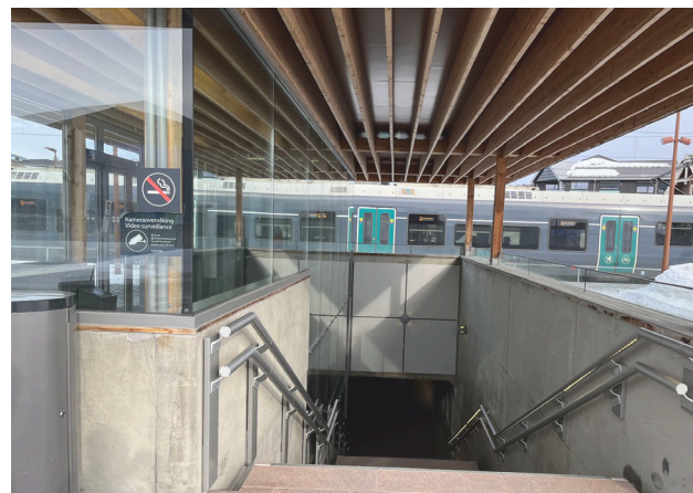
Foto viser hvor liten oversikt den reisende har ned til undergangen da den er helt mørklagt.
