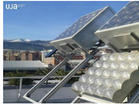
Figura 3.2 – Módulos fotovoltaicos de concentração localizados no terraço do edifício C6 pela Universidade de Jaen em Espanha [19].
