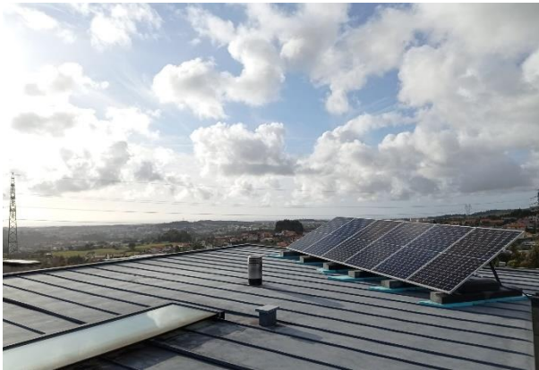
Figura 3.1 – Sistema fotovoltaico de autoconsumo.
