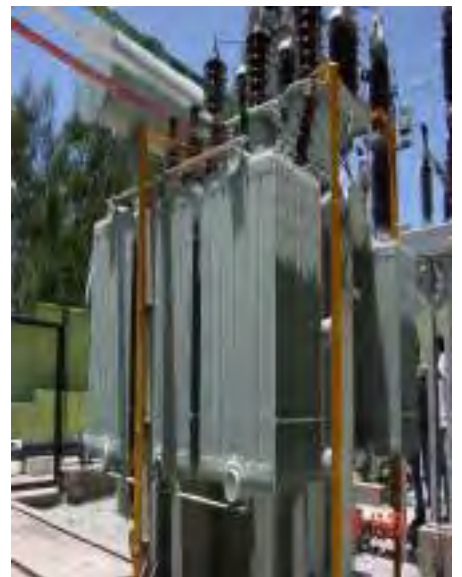
TRANSFORMADOR DE POTENCIA 3 MVA
