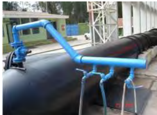
VÁLVULA DE PURGA / ÁRBOL DE DESCARGA LÍNEA DE IMPULSIÓN
