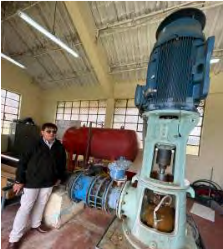
BOMBA DE IMPULSIÓN AKIPUMP DE LA CASETA DE BOMBEO 01
