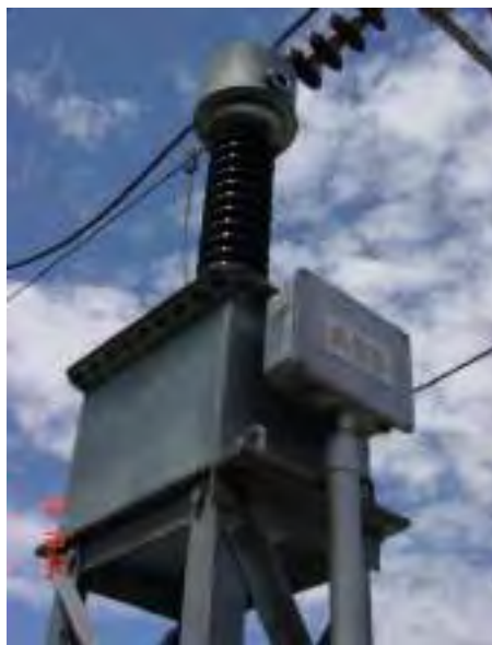
TRANSFORMADORES DE VOLTAJE MEDIA TENSIÓN
