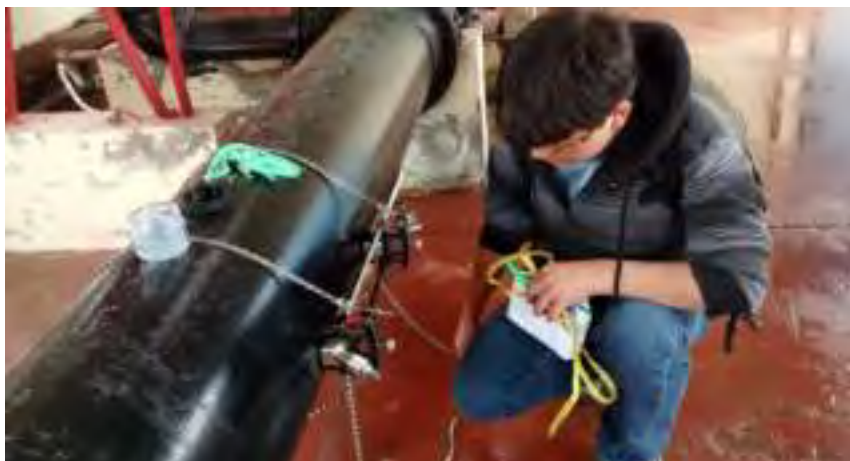
INSTALACIÓN DE CAUDALIMETRO ULTRASÓNICO DIGITAL P-T878 - Y MEDICIÓN DE LA PRODUCCIÓN DE POZO 01
