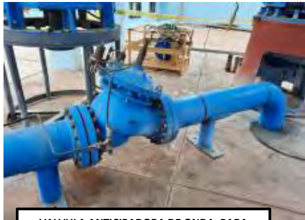
VALVULA ANTICIPADORA DE ONDA, PARA PROTECCIÓN DE GOLPE DE ARIETE EN ESTACIÓN DE BOMBEO
