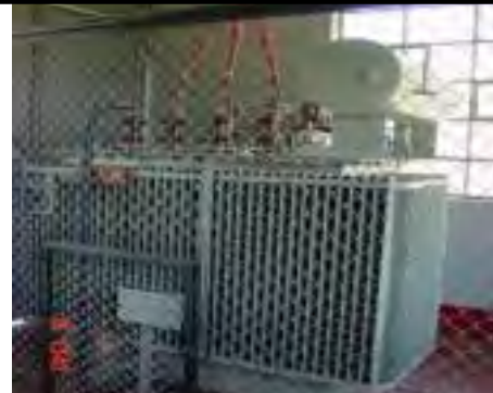
TRANSFORMADOR ELÉCTRICO – SALA DE CONTROL DE 1MVA
