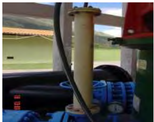
VÁLVULA DE AIRE – CONTROL/ ÁRBOL DE DESCARGA LÍNEA DE IMPULSIÓN
