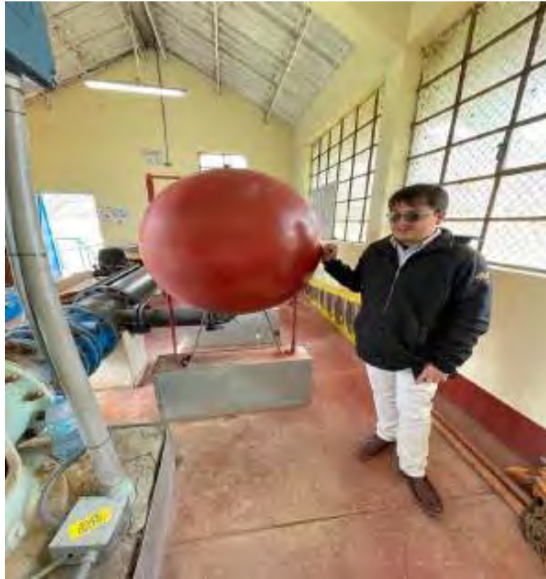
CALDERIN ANTIARIEDE DE 1'000 L (MIL LITROS) – CASETA DE BOMBEO 01 EB PIÑIPAMPA
