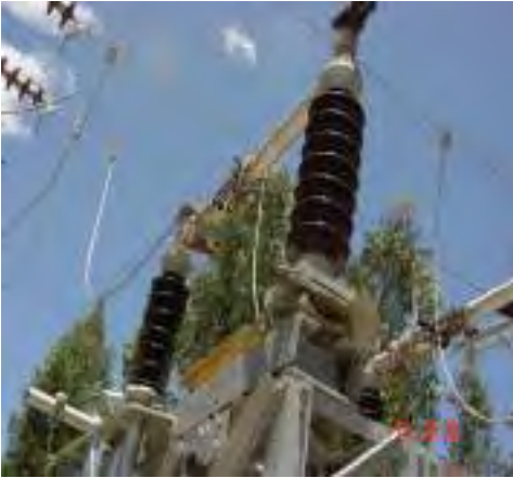
SECCIONADORES DE 60KV
