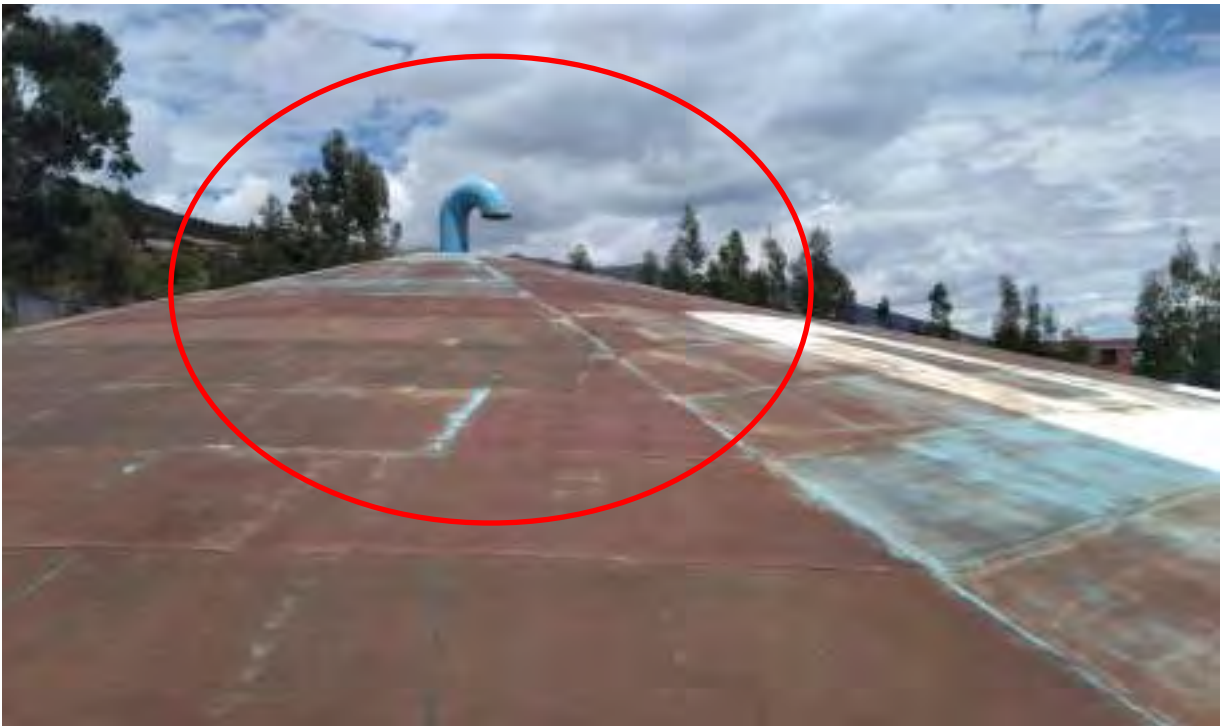
FOTO N° 41 : TUBERÍA DE VENTILACIÓN RESERVORIO R12
