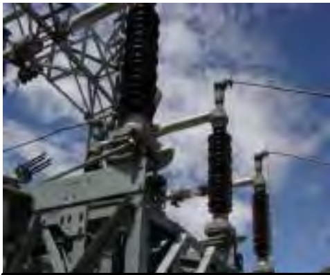
SECCIONADORES DE 60KV
