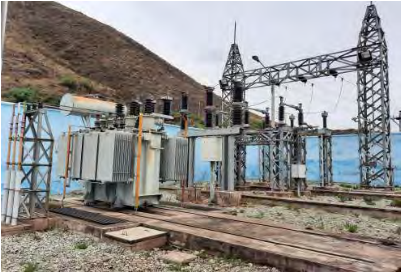
FOTO N° 17 : PATIO DE LLAVES – ESTACIÓN DE BOMBEO 02
