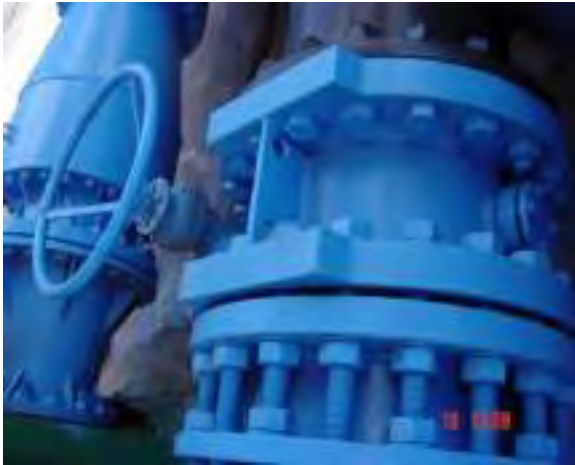
VÁLVULA MARIPOSA – CONTROL/ BOMBA 01
