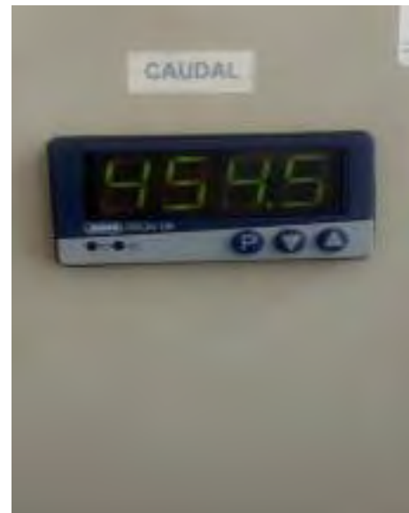
CAUDALÍMETRO ELECTROMAGNETICO DE MEDICIÓN DE CAUDAL DE PRODUCCIÓN EN LITROS / SEGUNDO
