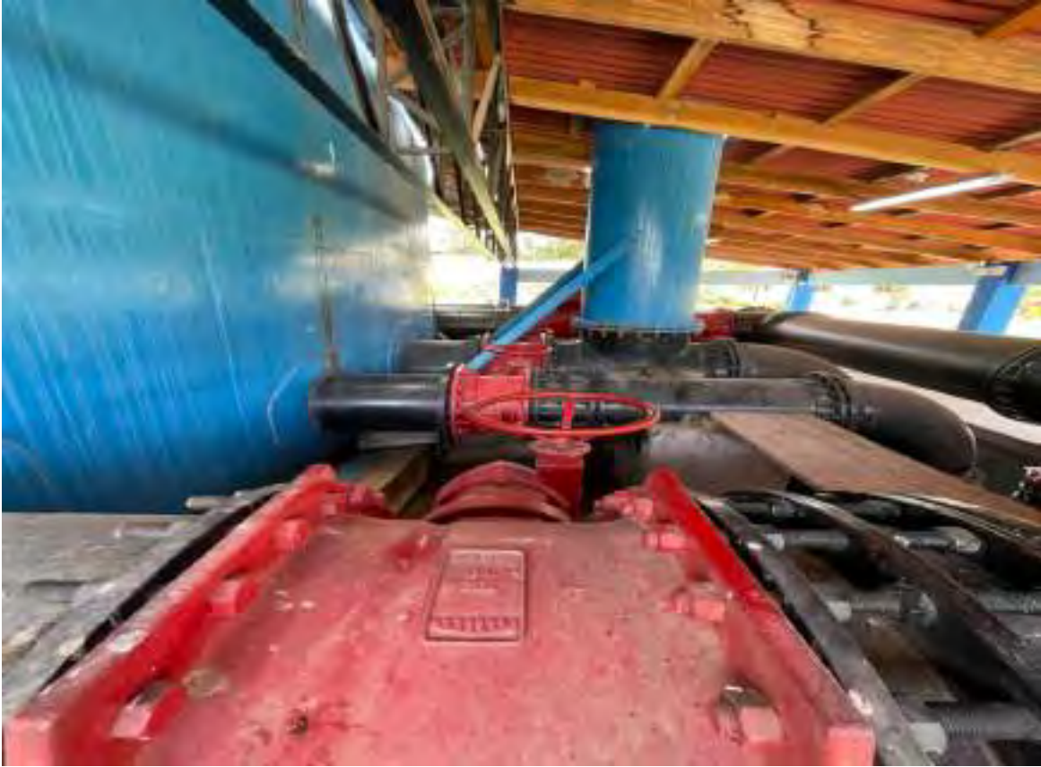
FOTO N° 37 : VÁLVULAS DE CONTROL MARIPOSA, SALIDA PARA ABASTECIMIENTO DE AGUA POTABLE A LA CIUDAD DEL CUSCO
