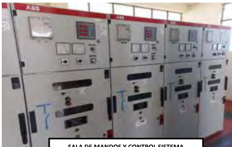
SALA DE MANDOS Y CONTROL SISTEMA ELÉCTRICO DE ELECTROBOMBAS.
