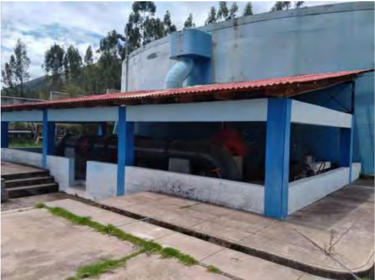
FOTO N° 40 : CASETA DE VÁLVULAS DE CONTROL RESERVORIO R12
