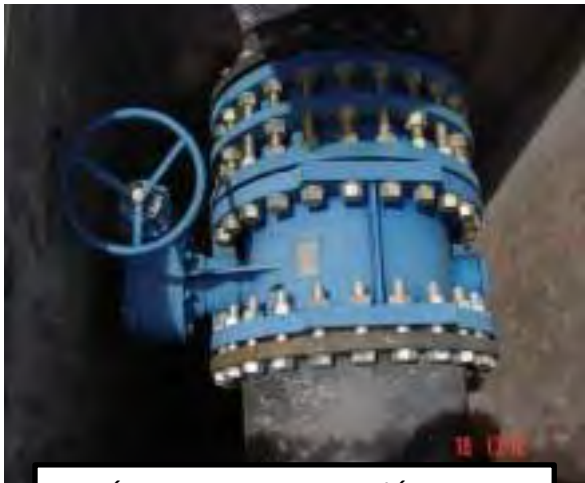
VÁLVULA CHECK – CONTROL/ ÁRBOL DE DESCARGA LÍNEA DE IMPULSIÓN
