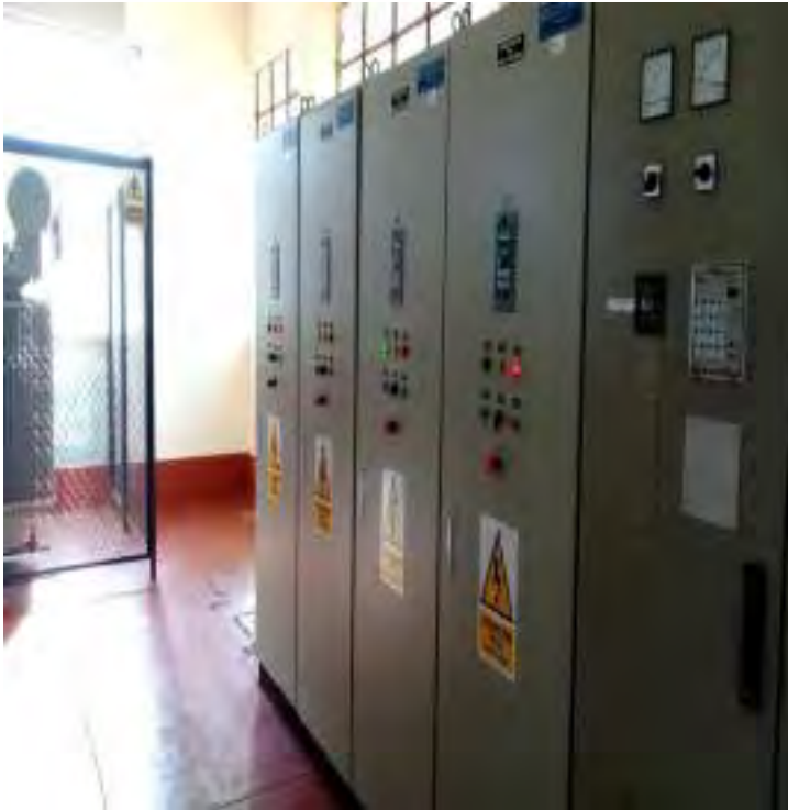
SALA DE MANDOS Y CONTROL SISTEMA ELECTRICO DE ELECTROBOMBAS.
