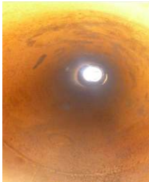
Figura 45 : Incrustación en tuberías de hierro dúctil recubierto, sistema de bombeo Pinipampa (Elaboración Propia)
