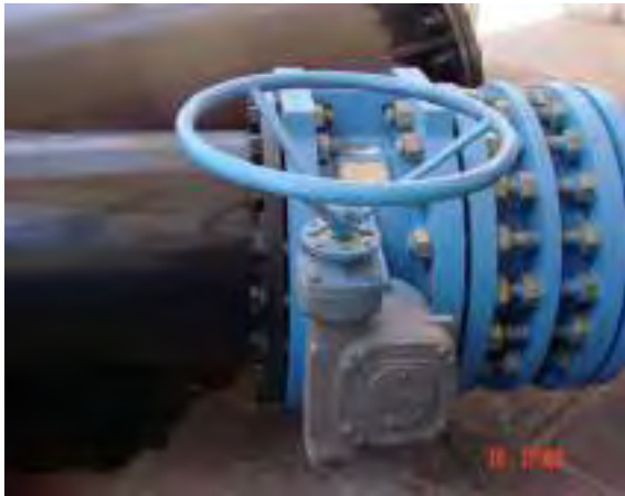
VÁLVULA MARIPOSA – CONTROL/ BOMBA 01
