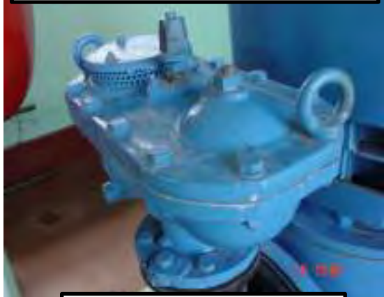
VALVULA DE AIRE, A SALIDA DE CAPTACIÓN POZO 01
