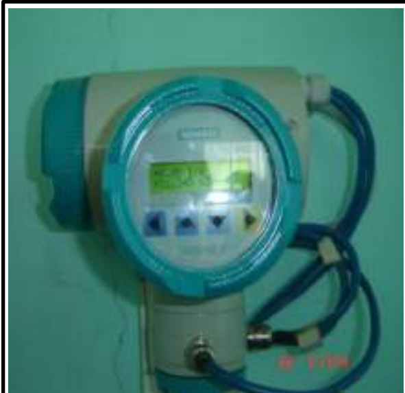
CAUDALIMETRO ELECTROMAGNETICO DE MEDICIÓN DE CAUDAL DE PRODUCCIÓN EN LITROS / SEGUNDO
