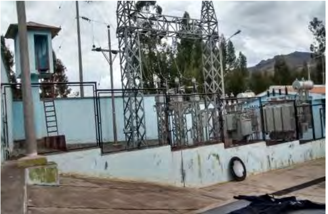
FOTO N° 30 : PATIO DE LLAVES – ESTACIÓN DE BOMBEO 03
