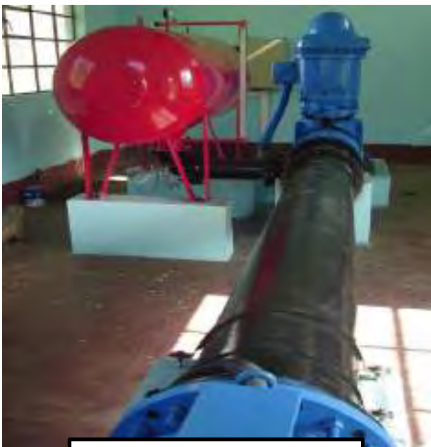
ÁRBOL DE DESCARGA - CASETA DE BOMBEO
