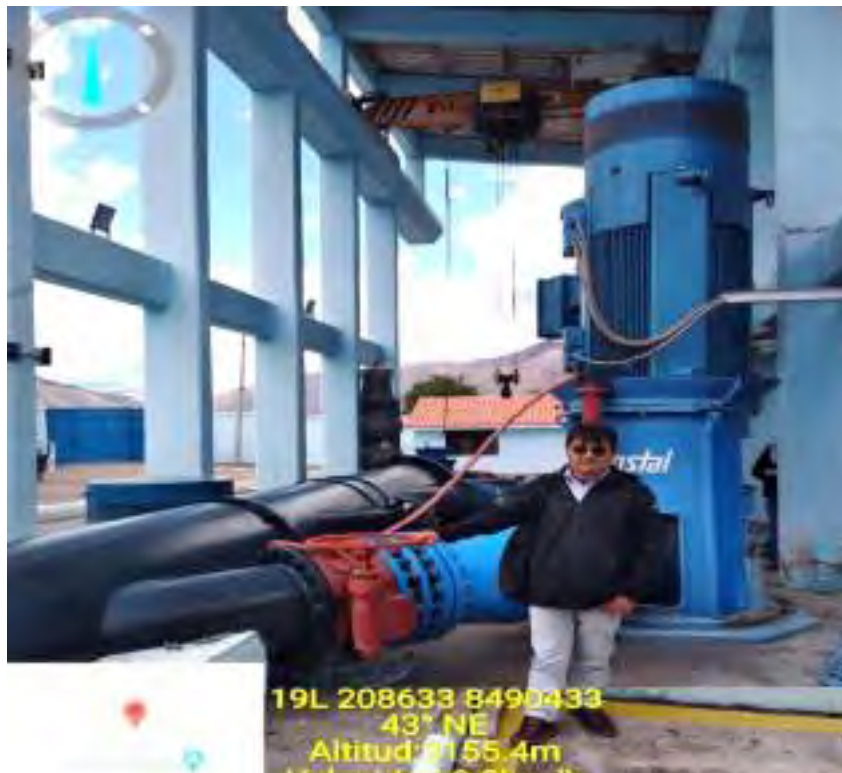
VERIFICACIÓN DE EQUIPOS DE BOMBEO HIDROSTAL , Y DISPOSITIVOS DE PROTECCIÓN EN ARBOL DE DESCARGA – EB RUMICOLA
