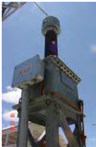
TRANSFORMADORES DE VOLTAJE MEDIA TENSIÓN
