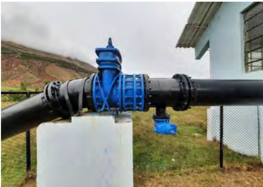
FOTO N° 4 : TUBERÍA DE 350 MM, A LA SALIDA DE CADA CASSETA DE BOMBEO PARA TENDIDO DE LINEA DE IMPULSIÓN
