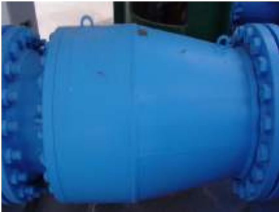
VÁLVULA CHECK – CONTROL/ ÁRBOL DE DESCARGA LÍNEA DE IMPULSIÓN
