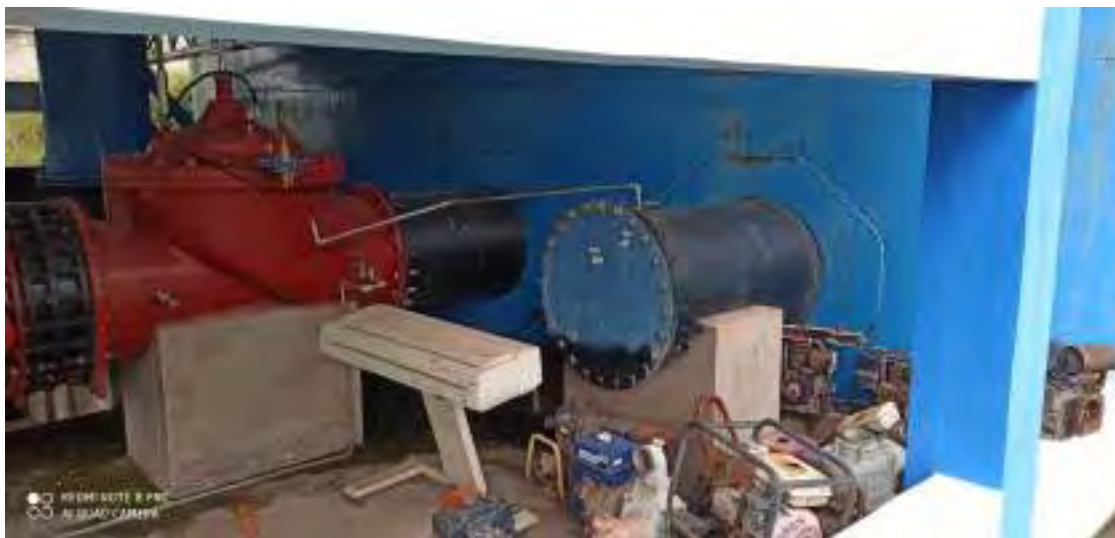
FOTO N° 38 : VÁLVULAS ANTICIPADORAS DE ONDA PARA PROTECCIÓN SISTEMA ANTI ARIETE LÍNEA DE DISTRIBUCIÓN
