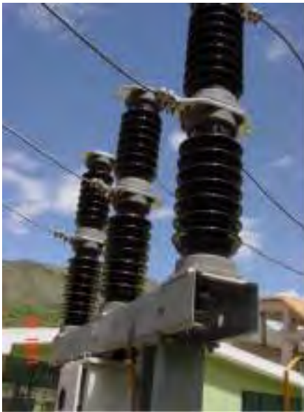
INTERRUPTORES PRINCIPALES 60KV
