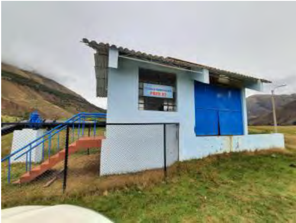
FOTO N° 4: ELECTRO BOMBAS, TIPO TURBINA VERTICAL PARA CAPTACIÓN DE AGUAS SUB-SUPERFICIALES CON SISTEMA DE PROTECCIÓN ANTI ARIETE
