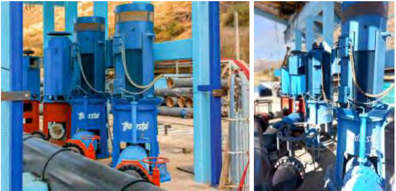
FOTO N° 13 : ELECTRO BOMBAS TIPO TURBINA VERTICAL PARA REBOMBEO A ESTACIÓN DE BOMBEO 03
