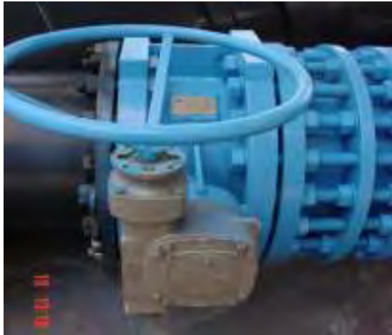
VÁLVULA MARIPOSA – CONTROL/ BOMBA 02
