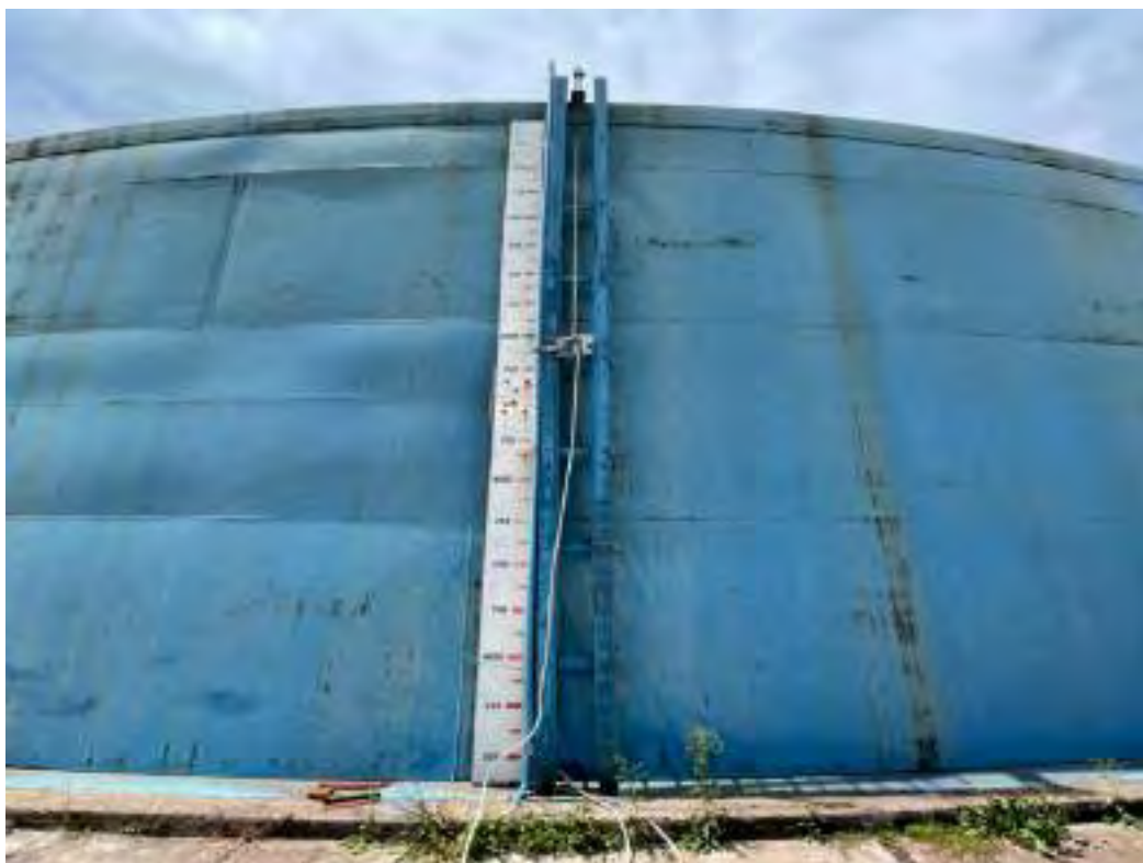
FOTO N° 39 : LIMNIMETRO DE MEDICIÓN DE NIVEL DE AGUAS DE RESERVORIO DE ALMACENAMIENTO R12
