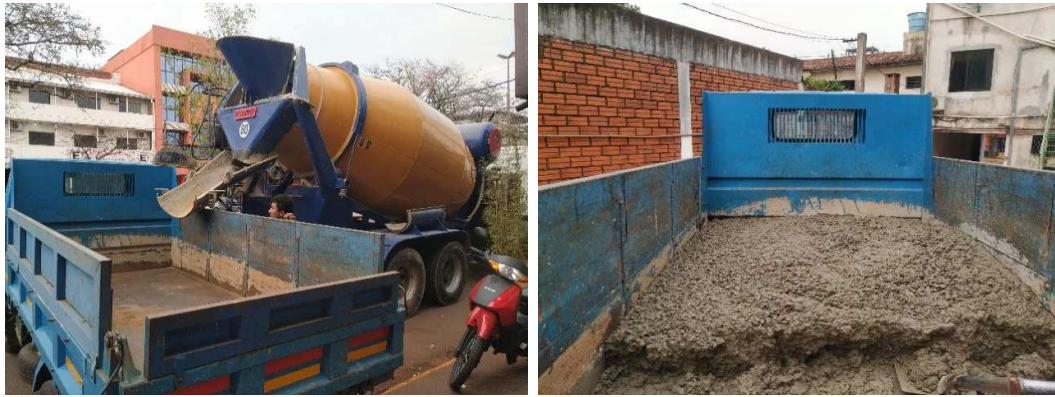
Figura 56: Camión Mixer provisionando el hormigón, traslado de la mezcla al sitio de fabricación de los cuerpos de prueba
