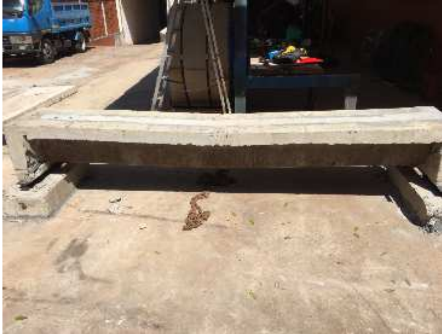
Figura 90: Vista de viga deformada, sin carga, viga V3
