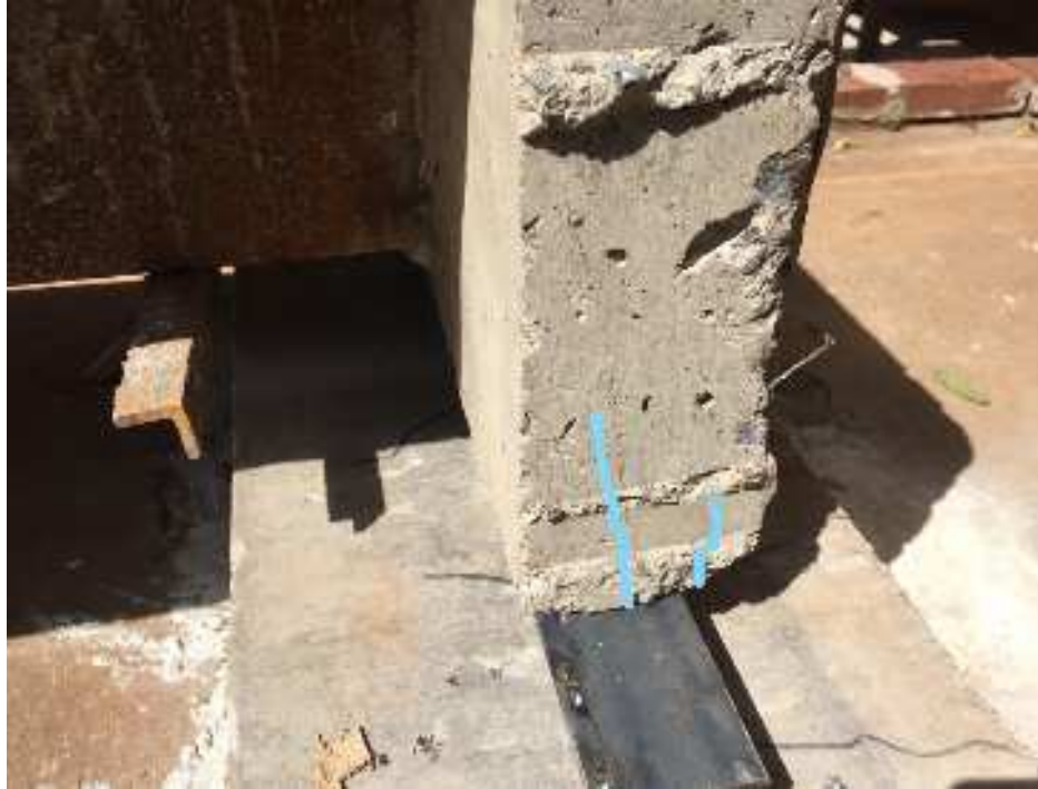
Figura 86: Fisuración apoyo de viga V1
