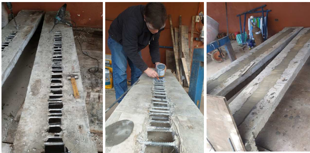
Figura 61: Vista del proceso de reparación con Graut, limpieza, pintado con epoxi, terminado
