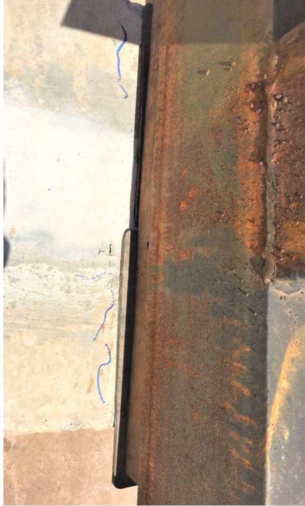
Figura 88: Fisura en mesa de compresión viga V2, se observa el actuador y las fisuras marcadas con tinta
