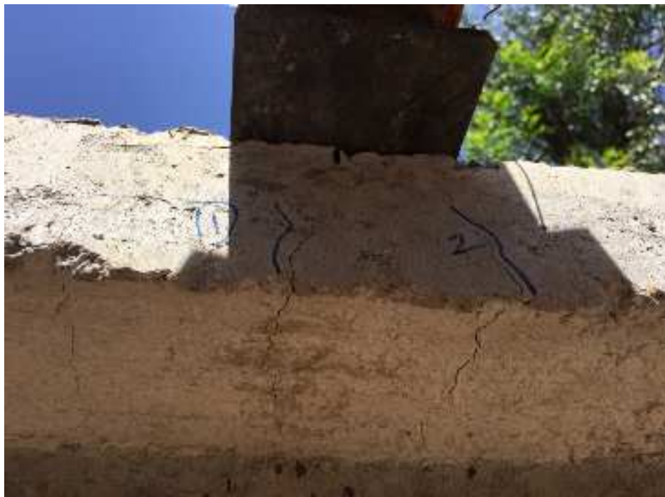
Figura 87: Fisuración lado inferior mesa de compresión viga V2
