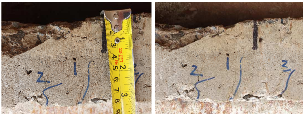
Figura 106: Disposición de fisuras, final de las fisuras medida desde el borde superior de la losa aproximadas a la profundidad calculada = 50 mm
