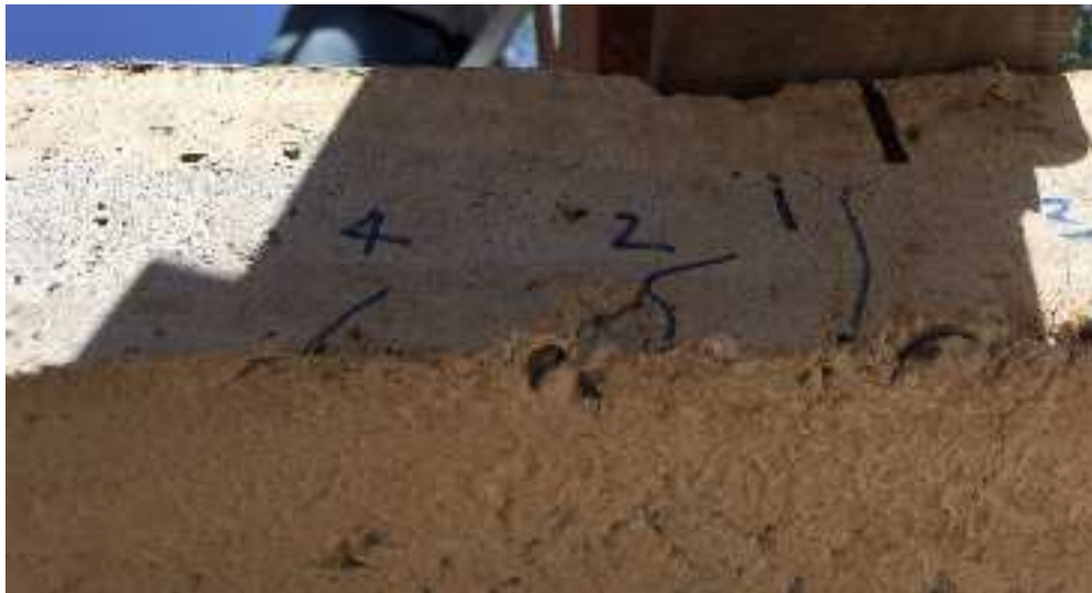
Figura 89: Fisuración lado inferior mesa de compresión viga V3
