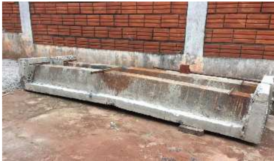
Figura 91: Vista inferior viga deformada, en viga V3 (volteada)
