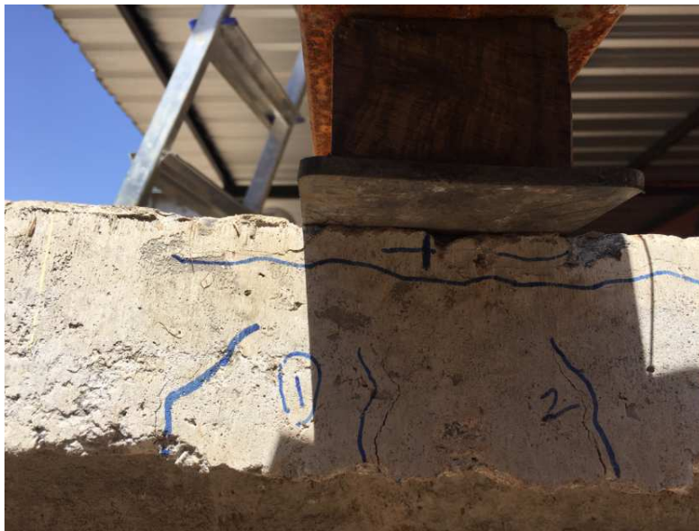
Figura 107: Disposición de fisuras en viga 3, vista de fisuras verticales y horizontal
