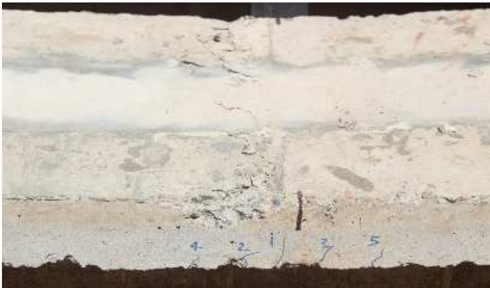
Figura 85: Fisuración en el centro de la mesa de compresión viga V1
