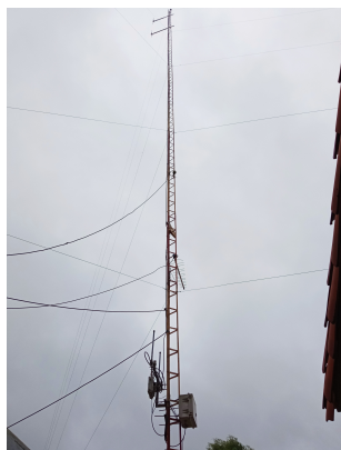
Figura 4.8: Antena de Comunicaciones de (Radio-Internet) CAMSAT Fuente propia
