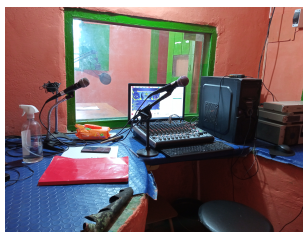
Figura 4.3: Cabina de Radio Tape Pyahu 87.9 FM) CAMSAT Fuente propia
