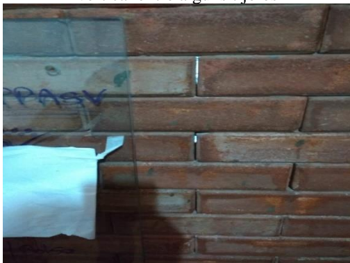
Figura 15 - Ausência de argamassa na junta vertical entre alguns tijolos
