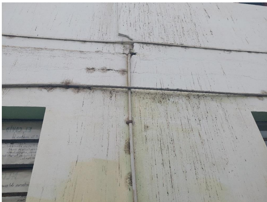
Figura 32. Se puede observar fisuras horizontales entre los muros y vigas de borde de la losa aligerada. Fuente: Propia.
