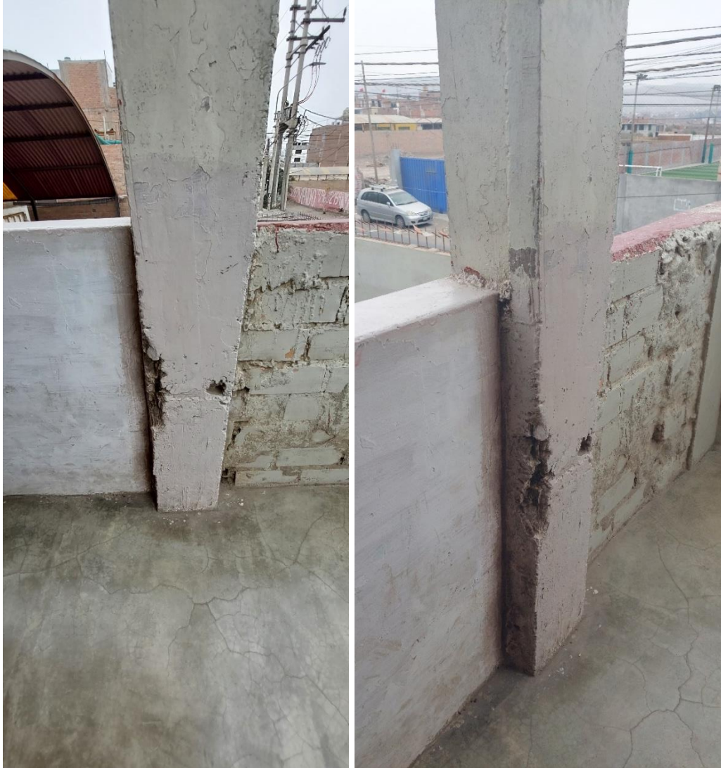
Figura 29. Se puede observar el desprendimiento del revestimiento en la columna. Además de cangrejas en el concreto. Fuente: Propia.
