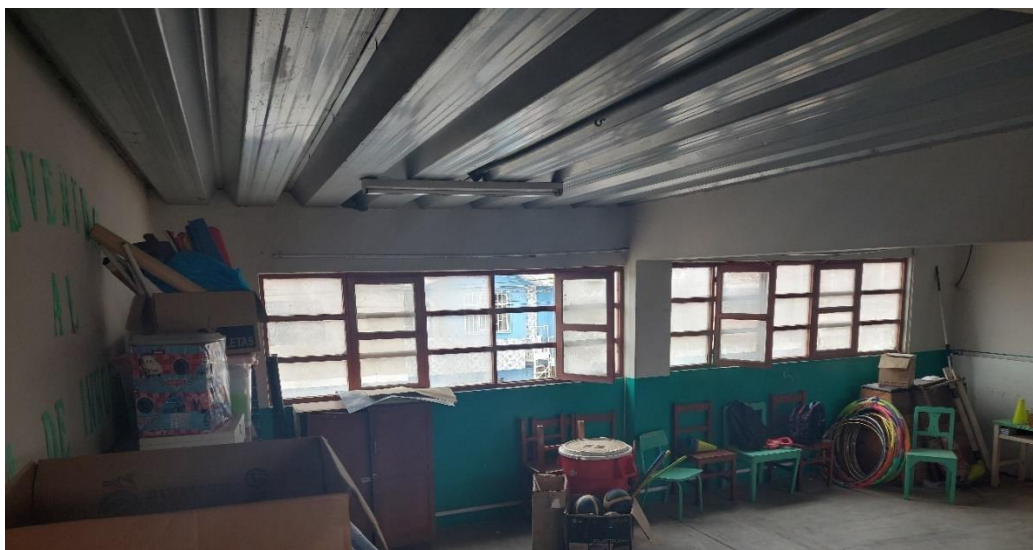
Figura 24. Se puede observar que la cobertura segundo piso es un techo de zincalum.
