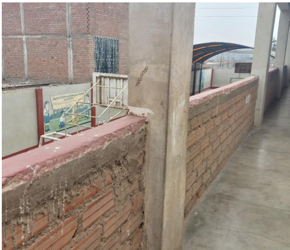
Figura 26. Se puede observar que el parapeto no se encuentra aislado sísmicamente de las columnas estructurales; por lo tanto, es probable que se presente una escenario de columna corta. Fuente: Propia.
