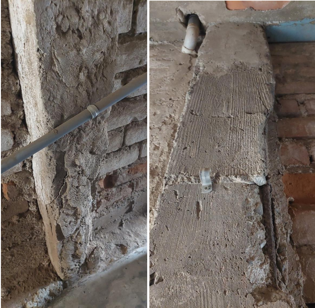
Figura 31. Se puede observar el desprendimiento del revestimiento en la columna, además de cangrejas en el concreto de la misma. Fuente: Propia.
