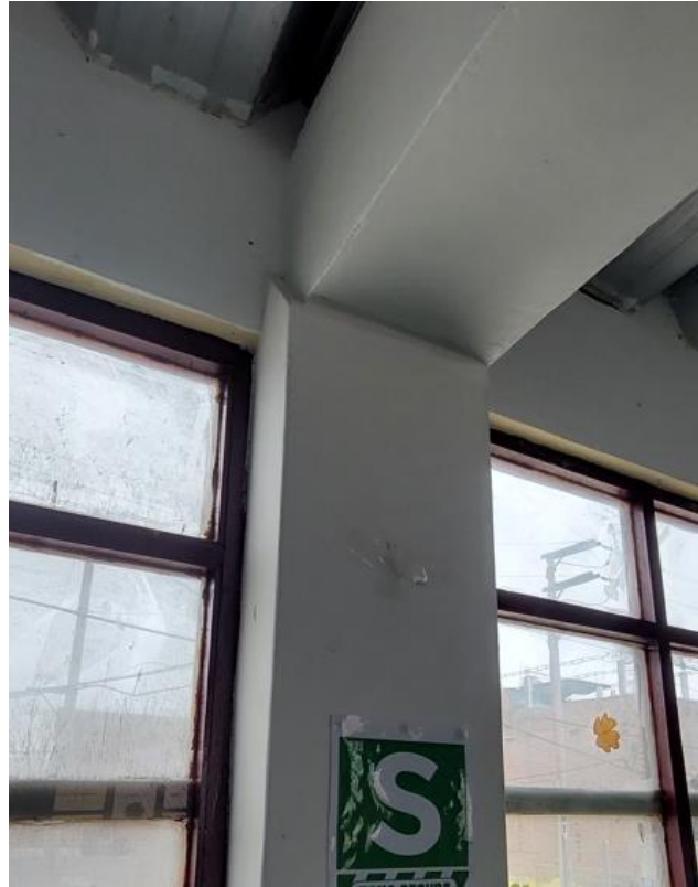
Figura 35. Irregularidad por vigas no alineadas con las columnas, ubicada en el aula de 5° grado del segundo. Fuente: Propia.
