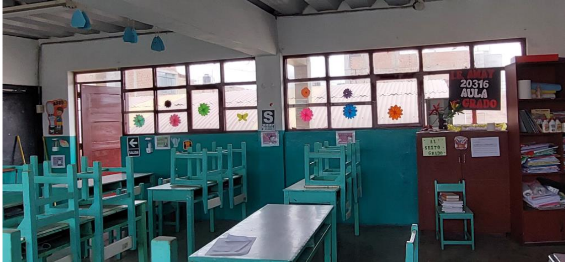
Figura 34. Irregularidad vertical por columna corta. Fuente: Propia.
