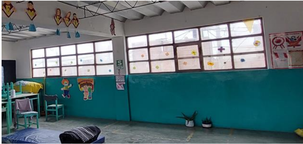
Figura 16. Se puede observar que no hay una adecuada distribución de muros (Aula del segundo piso), generándose un posible caso de columna corta en los vanos.
