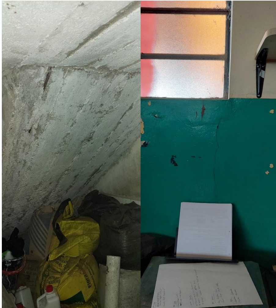
Figura 30. Se puede observar el desprendimiento del revestimiento en la cara interior de la losa de la escalera (izquierda) Se puede observar una fisura vertical en el alfeizar de la ventana (derecha). Fuente: Propia.
