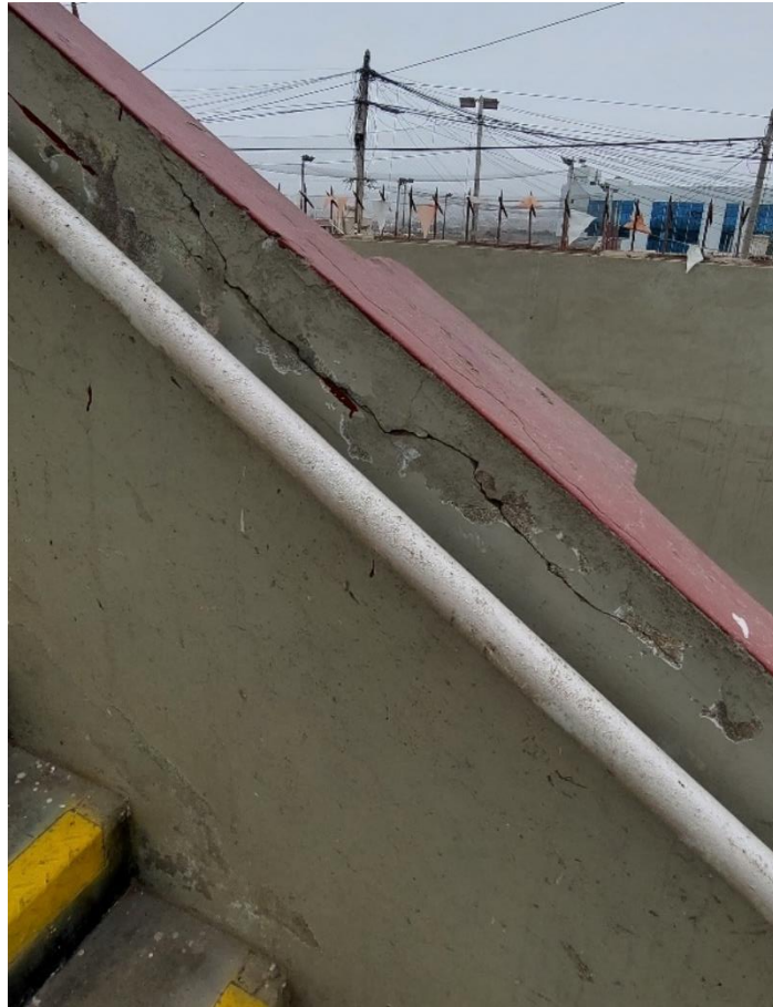
Figura 28. Se puede observar una rajadura aprox. de 3 mm en el parapeto de la escalera. Fuente: Propia.
