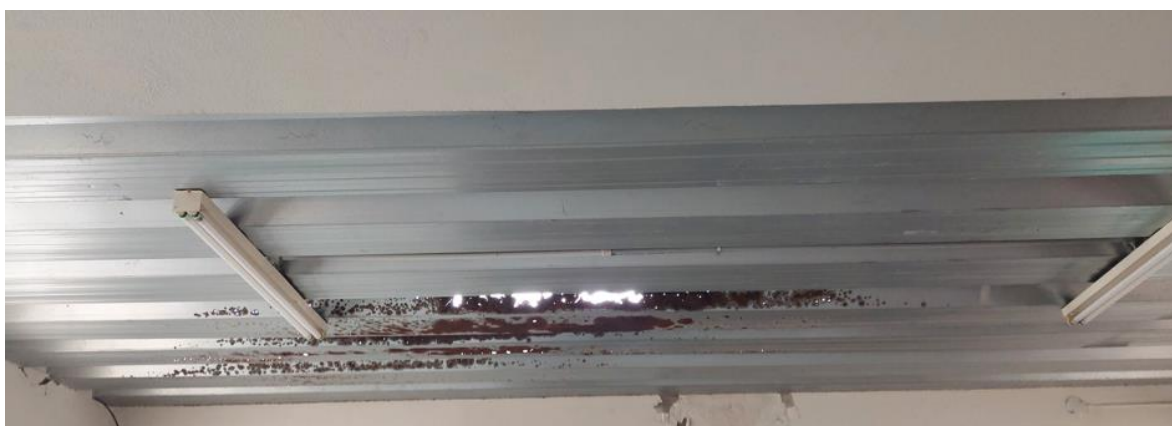
Figura 25. Se puede observar que un área de la cobertura del aula de Sexto Grado está en mal estado. Fuente: Propia.
