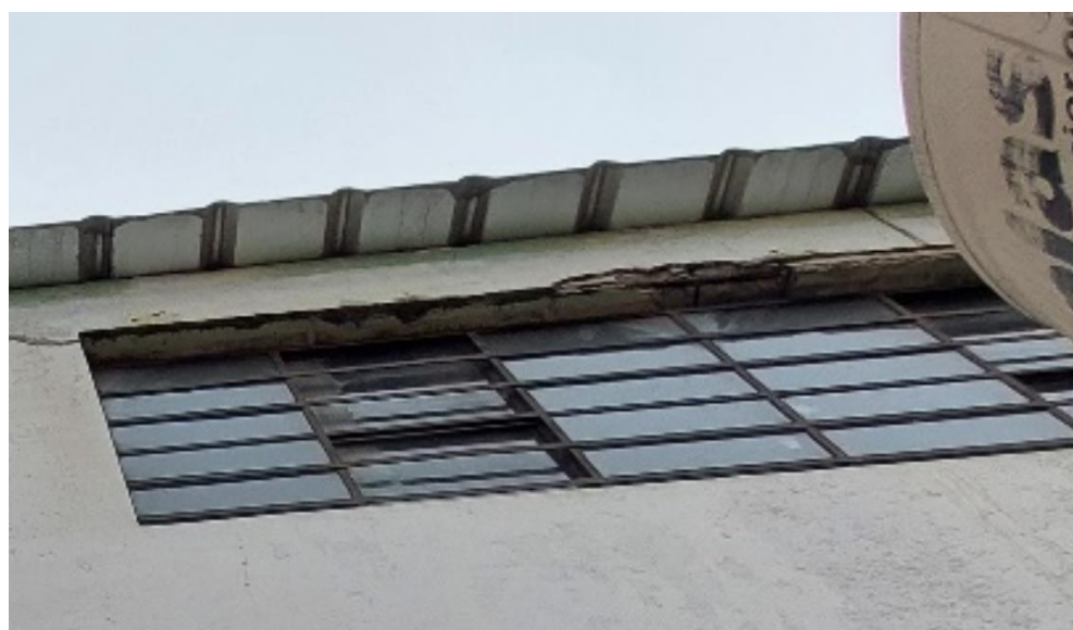
Figura 33. Se puede observar el desprendimiento del revestimiento en la viga, dejando expuestos, los cuales tienen un grado avanzado de corrosión. Fuente: Propia.
