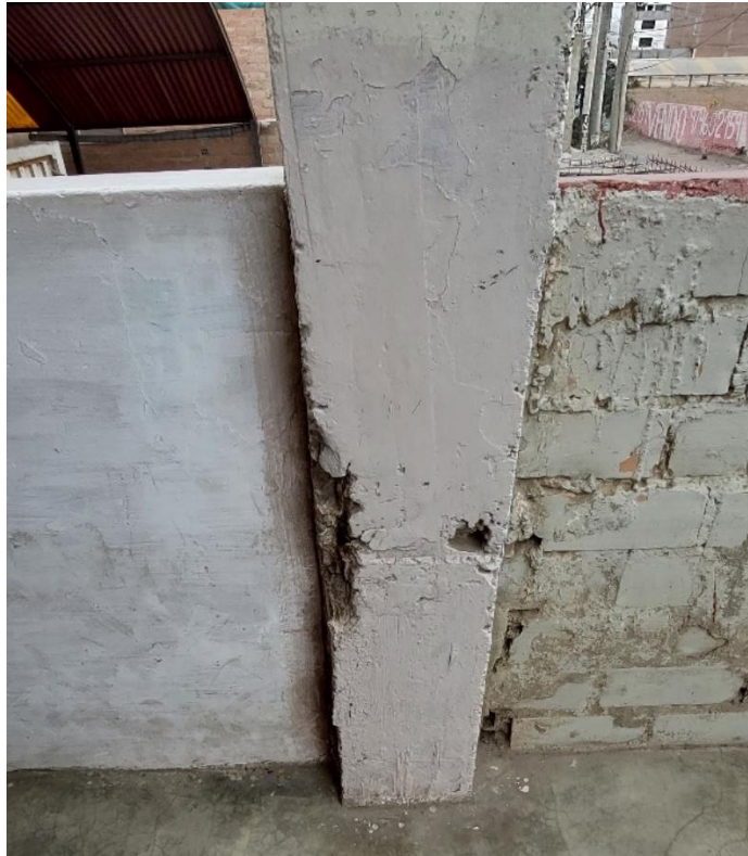
Figura 27. Se puede observar que los elementos estructurales y no estructurales se encuentran en mal estado. Fuente: Propia.
