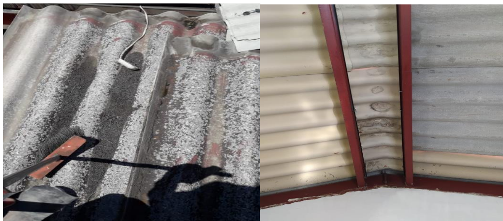
Ilustración 3-3: Techo con exceso de suciedad y fisuras
