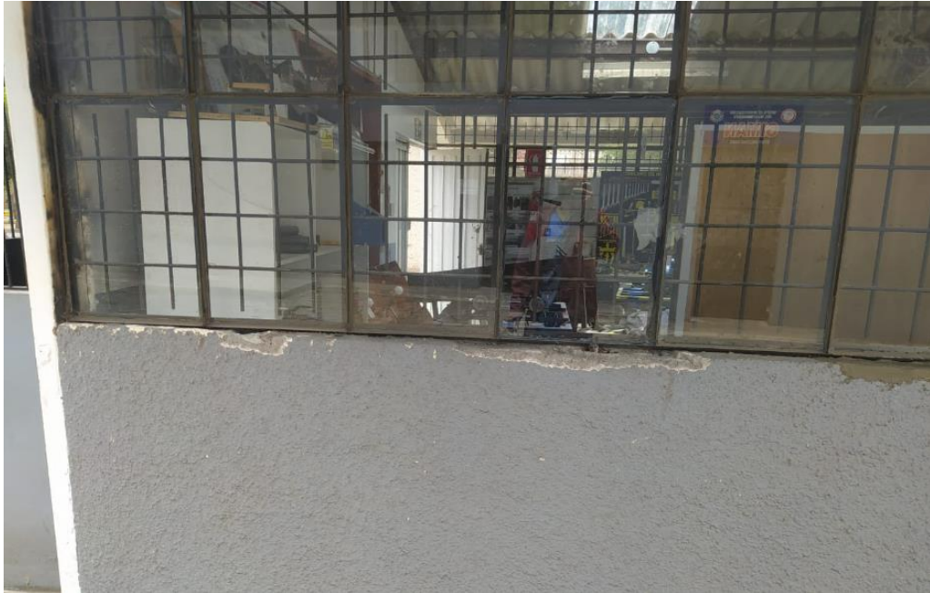
Ilustración 4-3: Fisuras en el exterior de las paredes
