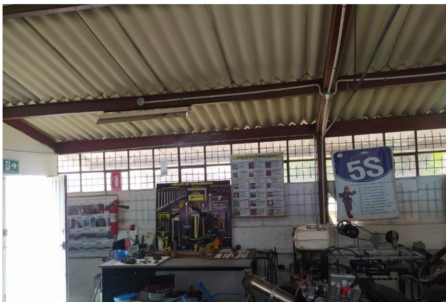
Ilustración 7-3: Falta de iluminación
