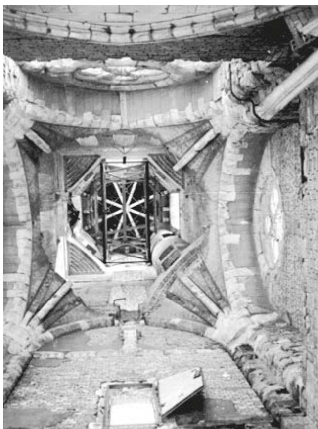
Abb. 60: Blick in den zerstörten Kirchturm
