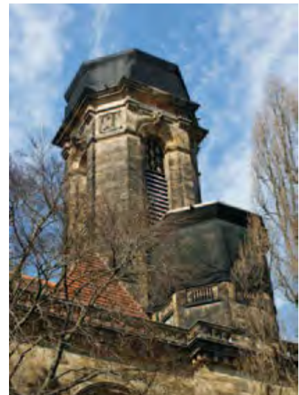
Abb. 138: Die Kirche wurde von 1963 bis 1972 in vereinfachter Form wiederaufgebaut, bis heute fehlen die Turmspitze des Hauptturmes und die Haube des Nordostturmes.
