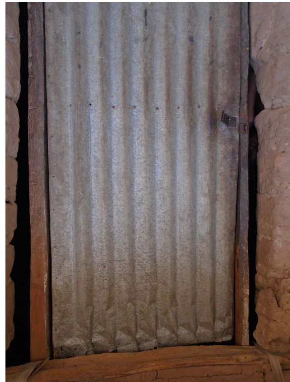
Fig. 6 PV Bad door
