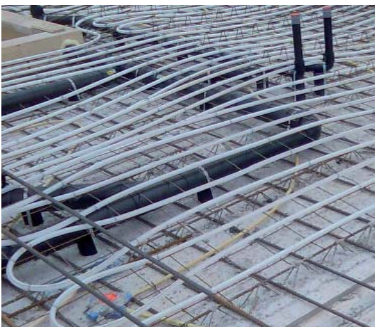
Figuur 5.12 Vloerwarming is een afgiftesysteem, maar valt onder de groep leidingen [Foto Bouwbedrijf Coppes].
