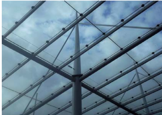
Figuur 5.5 Structural glazing is een voorbeeld waarbij is nagedacht over de integratie en koppeling tussen gevel en constructie.
