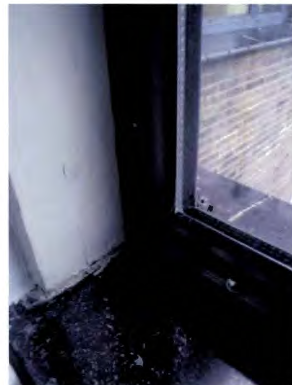
47 - Poging tot introductie van isolerende beglazing
