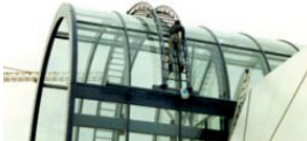
figuur 6 Gevelonderhoudsinstallatie (Bron: Jomy B.V.)
