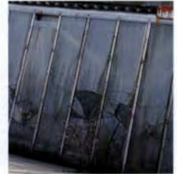
afbeelding 6.17 Gebroken ruiten; ENKA, Ede, 2008.
