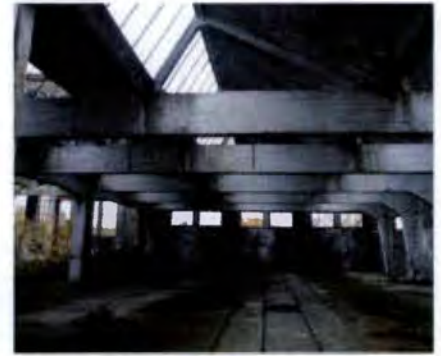
afbeelding 6.14 Ontbrekende beglazing en planten-groei; ECI, Roermond, 2009.
