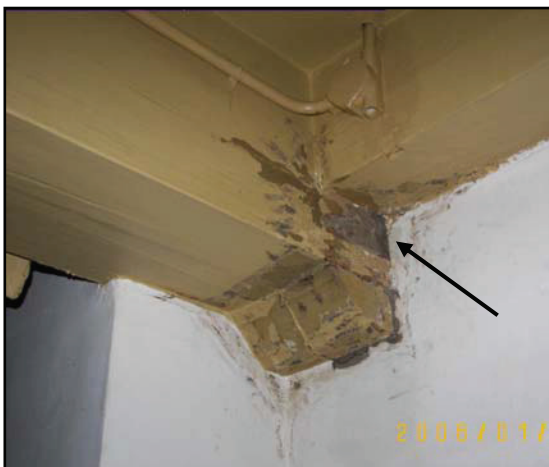
Figuur 4 Afbeelding van een met behulp van epoxyhars gerestaureerde balkkop in een 17 de eeuws grachtenpand waar luchtbevochtiging wordt toegepast. Waarschijnlijk ten gevolge van inwendige condensatie in de buitenwand, is er rotting opgetreden aan de balkkop.
