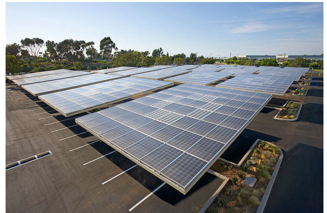
Afbeelding 3.6 Zonnepanelen boven parkeren
