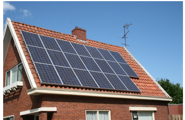
Afbeelding 3.5 Zonnepanelen op het dak
