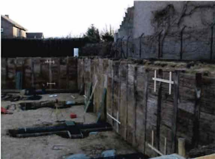
Abbeelding 2.3.1.1: Berliner wand toegepast bij de aanleg van een parkeergarage voor de Sint Maartenskliniek te Nijmegen
