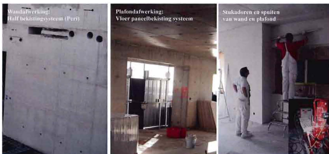
Figuur 10: Kwaliteit van wand en vloer na ontkisting tot aan stukadoren en spuiten van wand en vloer
