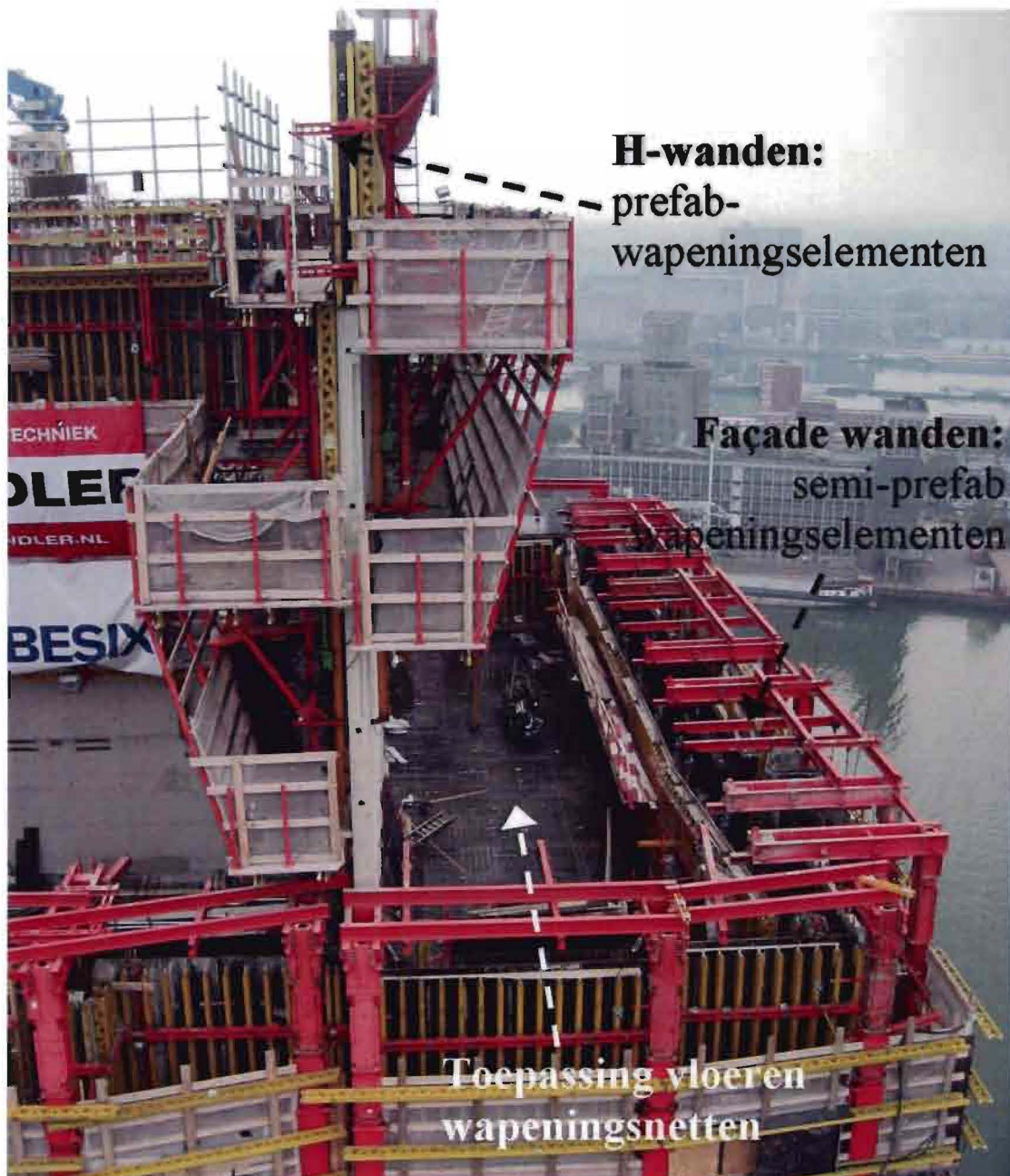
Figuur 48: Overzicht van toepassing wapening t.p.v. de H-wanden en Façade wanden en vloeren
