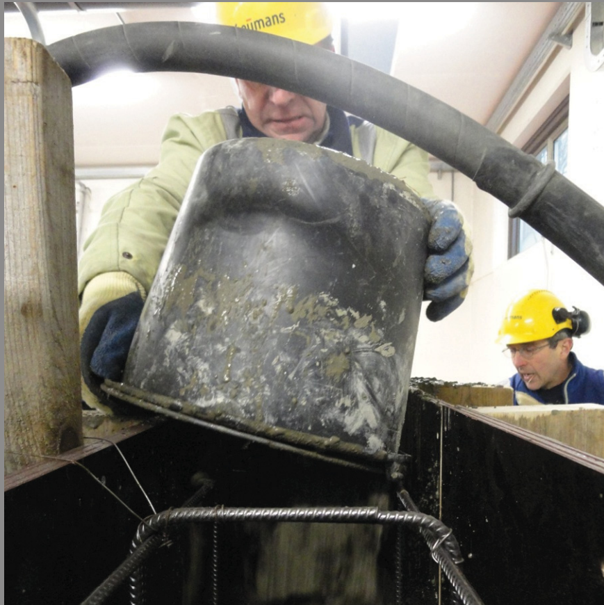
Afbeelding van het bewerkelijk starten van beton met behulp van kruitwagen en emmer
