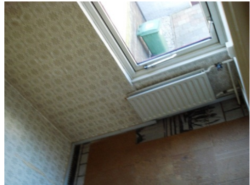
Figuur 47: CV radiator, leidingen in het zicht
